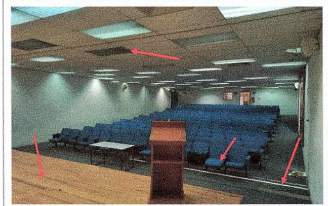
F5: Interior de auditorio donde se realizaron trabajos de rehabilitación de plafon, cambio de butacas deterioradas, rehabilitación de duela y cambio en un área de alfombra.
