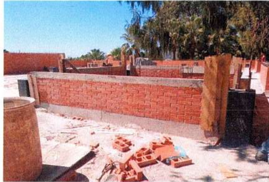
F88: Colado con concreto hecho en obra de cadena de enrase en muro de cubo de escaleras
