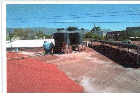
F14: Aplicación de impermeabilizante acrílico en losa de azotea de edificio B
