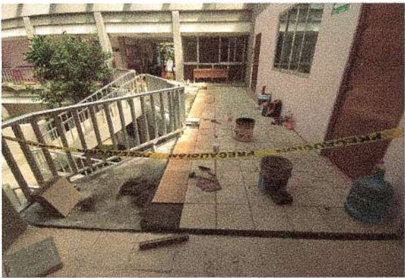
F17: Suministro y colocación de piso de granito en pasillo de acceso.
