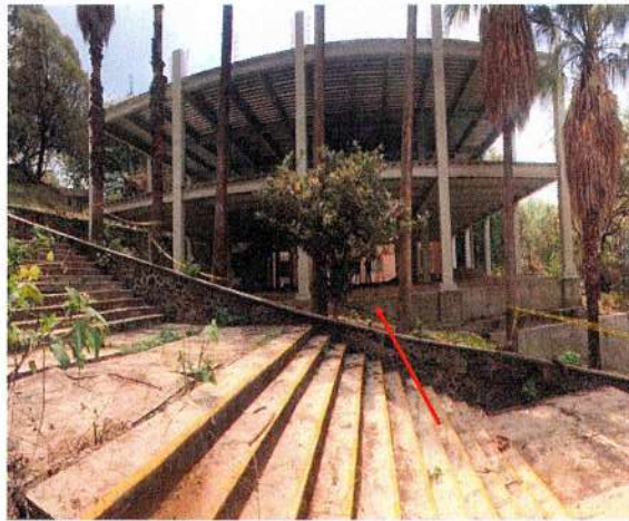
F2: Fachada Oeste - Construcción de la segunda etapa para la ampliación de laboratorios, cubículos de investigación, y oficinas académicas para el Centro de Investigaciones Biológicas antes CEIB (etapa final).
