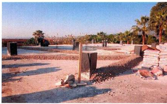
F19: Tendido de grava de tezontle para relleno de entortado en azotea
