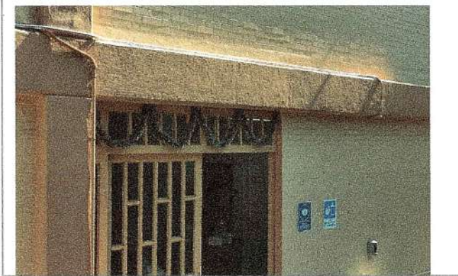
F15: Alimentación eléctrica para bombas de agua
