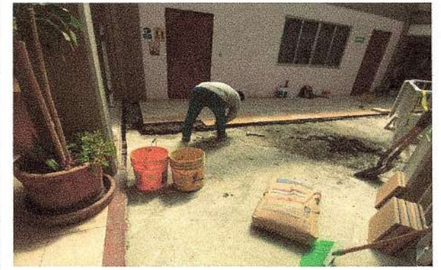
F16: Suministro y colocación de piso de granito en pasillo de acceso.
