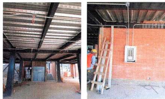
F40: Tendido de cable y colocación de tablero de cobre para instalación eléctrica
