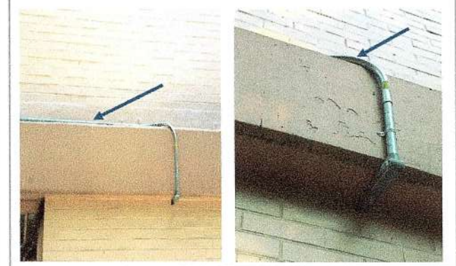
F16: Alimentación eléctrica para bombas de agua
