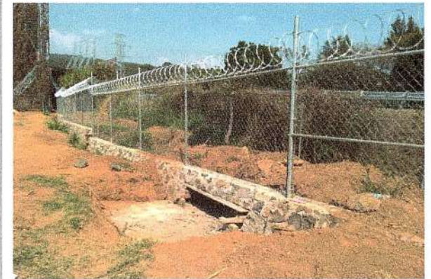
F27: Suministro y colocación de malla tipo ciclónica, cerca de navajas y boca de tormentas
