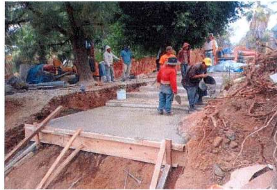
F115: Colado con concreto hecho en obra de escalones y descansos de andador de acceso principal
