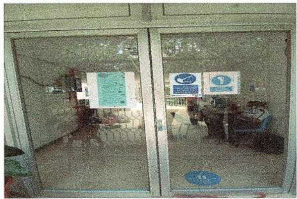
F50: Reparación de puerta de aluminio de acceso principal (cambio de chapa).
