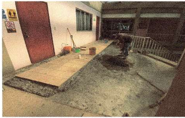
F15: Suministro y colocación de piso de granito en pasillo de acceso.
