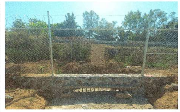
F19: Suministro y colocación de malla tipo ciclónica, cerca de navajas y bora de tormentas
