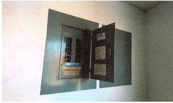
F24: Identificación de circuitos en tablero
