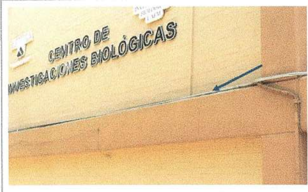
F14: Alimentación eléctrica para bombas de agua
