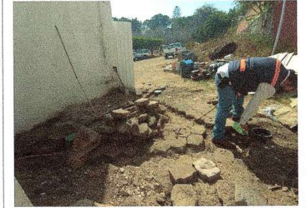
F50: Suministro y colocación de cable de cobre para sistema de puesta a tierras
