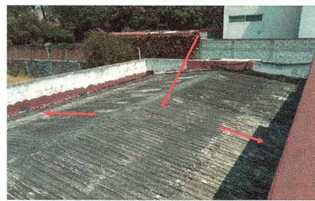
F4: Vista superior de techumbre metálica y canalon perimetral que se sustituirán.
