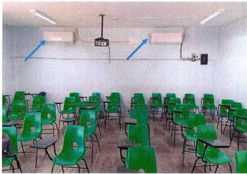
F15: 2 Sistemas de Aire Acondicionado de 2 Toneladas se ubicaron en el Aula 1 del Edificio B.
