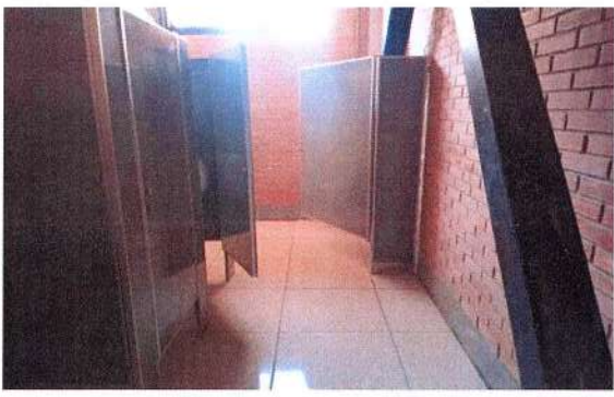
F145: Suministro y colocación de mamparas divisorias de sanitarios. Suministro y colocación de muebles de sanitarios (w.c., lavabos y mingitorios)
