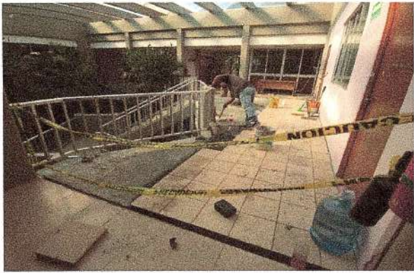
F14: Suministro y colocación de piso de granito en pasillo de acceso.
