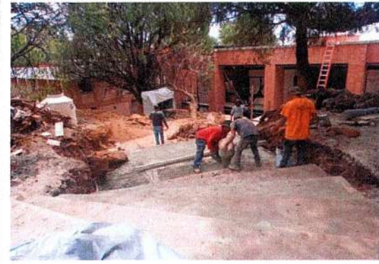
F116: Colado con concreto hecho en obra de escalones y descansos de andador de acceso principal
