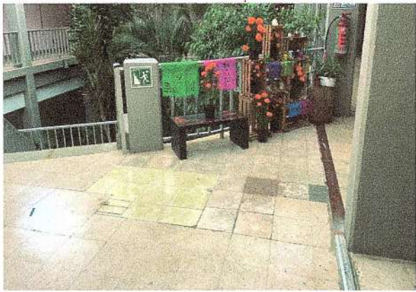
F6: Piso de granito existente diferentes tonos en pasillo de acceso.
