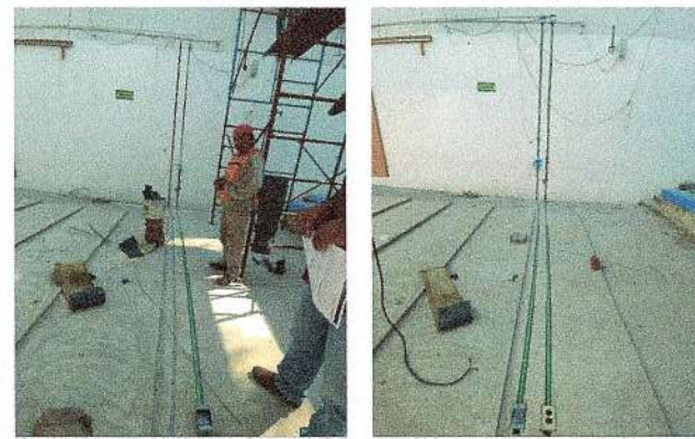
F13: Suministro y colocación de tubería de pvc pesado para instalación eléctrica y voz y datos.
