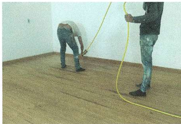
F55: Suministro y aplicación de barniz sobre piso de duela en estrado
