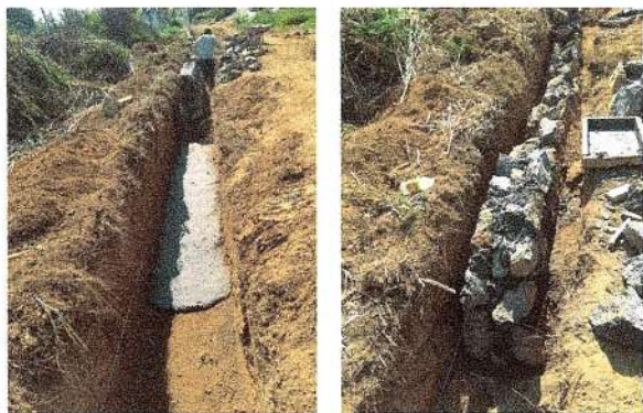
F11: Plantilla de concreto hecho en obra y rodapie de mampostería
