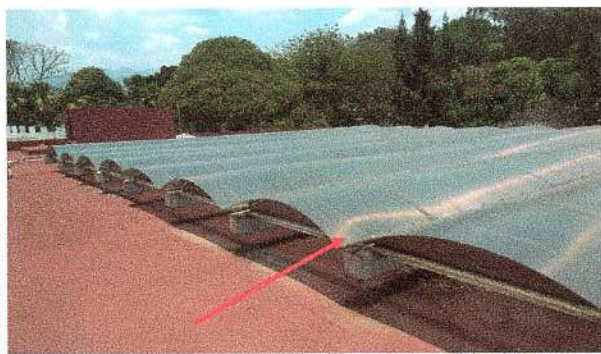
F3: Mantenimiento general correctivo a domo de policarbonato en losa de azotea de edificio del CINCCO.
