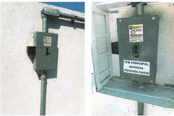
F18: Conexión y etiquetado de interruptor en caja moldeada de 3 polos por 100 amperes
