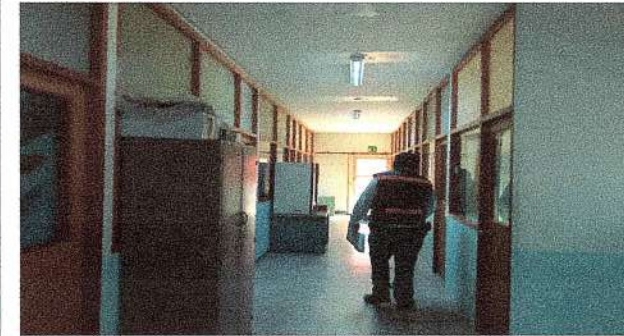
F4: Mantenimiento a red eléctrica: Incluyendo colocación de luminarias y separación de circuitos
