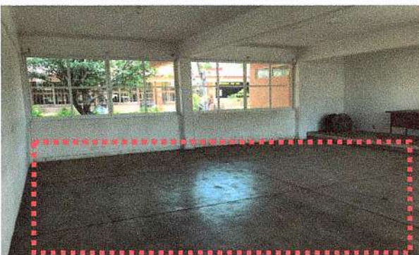
F3: Interior de Aula tipo - Se realizaron trabajos de colocación de loseta.
