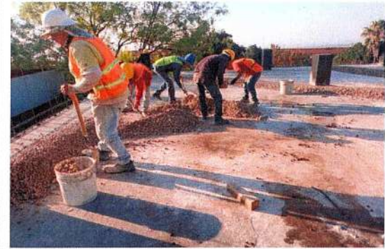
F17: Tendido de grava de tezontle para relleno de entortado en azotea
