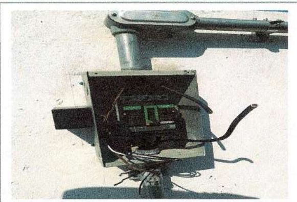
F12: Conexión y colocación de interruptor termomagnético y supresor de picos para sistema fotovoltaico
