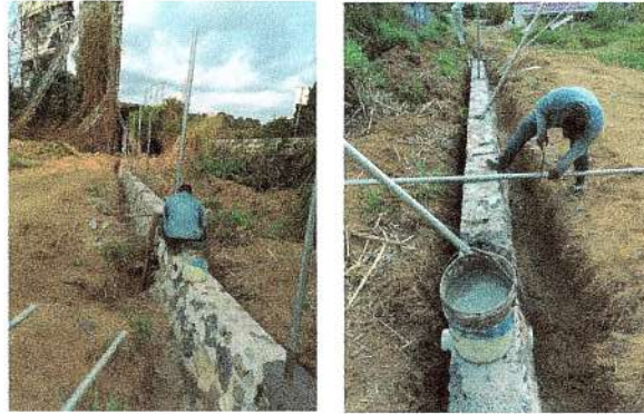
F15: Suministro y colocación de postes galvanizados para cerca de malla tipo ciclónica
