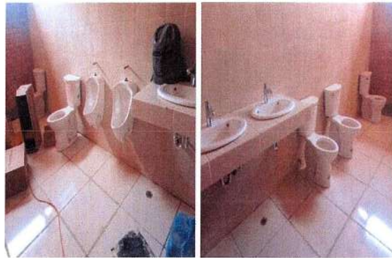
F121: Suministro y colocación de muebles de sanitarios (w.c., lavabos y mingitorios)
