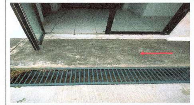
F5: Demolición de firme y construcción de rampa de concreto en salida de emergencia
