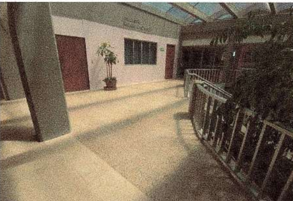
F47: Suministro y colocación de piso de loseta en pasillo de acceso.
