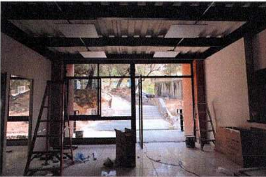
F123: Colocación de piso de loseta, muros divisorios de tablaroca y cancelería en color negro.
