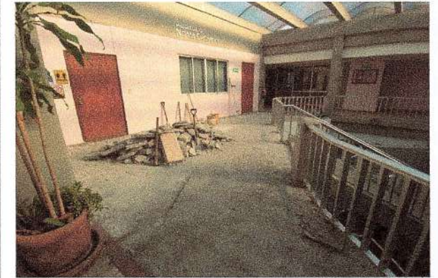
F13: Apilado de escombros en el sitio.
