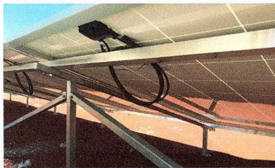
F22: Conexión de paneles solares
