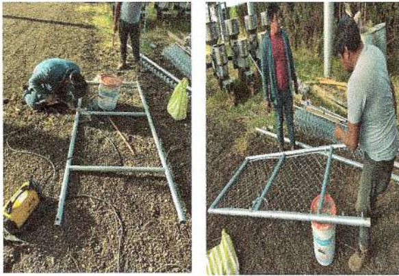
F23: Elaboración de puerta de acceso a apiario con tubo galvanizado y malla ciclónica
