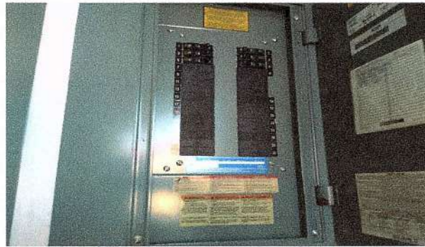
F25: Identificación de circuitos en tablero
