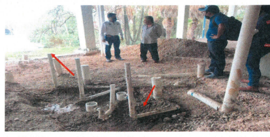
4.- Colocación de instalación hidrosanitaria en modulo de baños y laboratorio, rellenos y compactación, firme de concreto, colocación de loseta, fabricación de muros de tabique y vintex, cancelería, colocación de plafón, muebles sanitarios.
