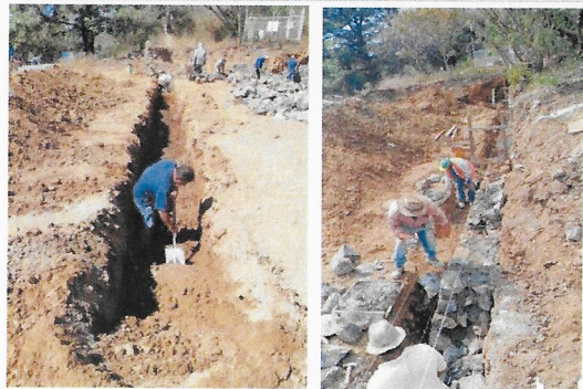
F12: Excavación de terreno y construcción de muro de mampostería para plataforma
