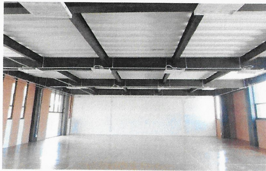
F47: Suministro y colocación de acabado con barniz sobre oxireto, aplicación de pintura vinílica color blanco, instalación de cancelería.
