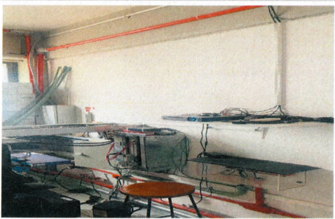
F12: Se equipará el cuarto Site Edificio 30, con 1 aire acondicionado.
