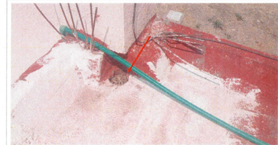
F5: Mantenimiento al sistema de impermeabilización de losa en el edificio 1 de Escuela de Estudios Superiores de Jonacatepec subsede Axochiapan. Cubierta de entrepiso, detalle de sistema de coladera pluvial existente en fachada sur.
