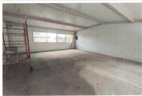
F3: Se equipará el Salón de clases móvil 1, con pizarrón proyector y pantalla.
