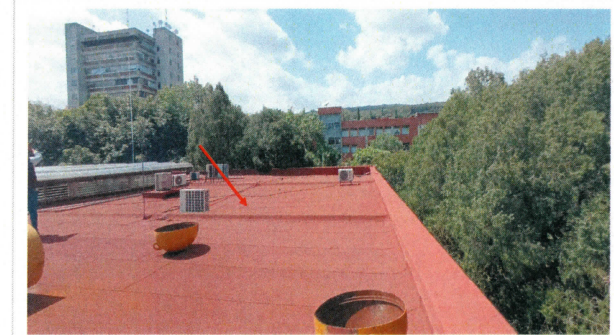
F5: Mantenimiento de impermeabilizante en losa del edificio del Centro de Investigación en Ciencias (CInC). Lado Este del edificio.
