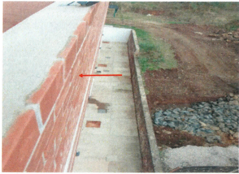
F6: Mantenimiento al sistema de Impermeabilización existente del edificio No. A 70. Impermeabilización de Muros Exteriores, Fachada Este.
