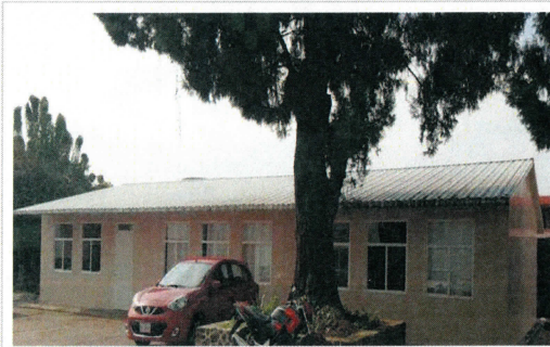
F4: Impermeabilización de cubierta, muros laterales, fachadas y base de caseta prefabricada a los salones y laboratorio de docencia del programa educativo de la Licenciatura en Diseño Molecular y Nanoquímica del Centro de Investigaciones Químicas (CIQ).
