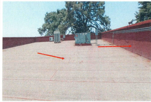
F3: Adecuación y Mejoras de la Cubierta y "Huerto Solar" en la Biblioteca Central. Trabajos de impermeabilización, en losa de azotea y pretel, colocación de sistema fotovoltaico (huerto solar) Área de auditorio
