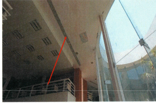
F10: Adecuación y Mejoras de la Cubierta y "Huerto Solar" en la Biblioteca Central. Trabajos de sustitución de plafón, área interior central.
