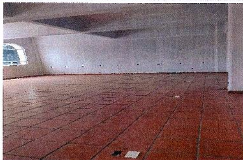
F3: Se equipará el Salón 2, con silla y mesa binaria.
