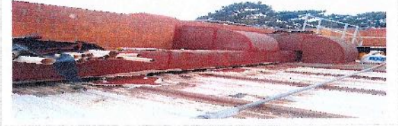
F22: Desprendimiento de impermeabilizante y chafalón existente
