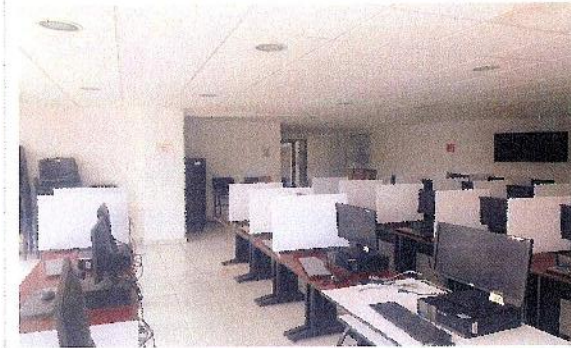
F8: Se equipará al Centro de Cómputo con 1 aire acondicionado.
