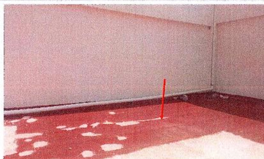
F4: Mantenimiento al sistema de impermeabilización de losa en el edificio 1 de Escuela de Estudios Superiores de Jonacatepec subsede Axochiapan. Cubierta de entrepiso, fachada suroeste.
