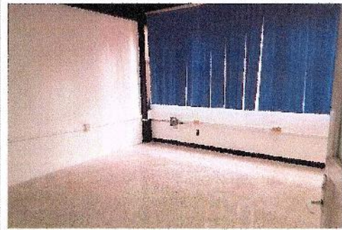
F12: Se equipará el Salón de clases 1, edificio 13 planta baja, con ventilador.
