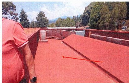
F4: Adecuación y Mejoras de la Cubierta y "Huerto Solar" en la Biblioteca Central. Trabajos de impermeabilización en losa de azotea y perfil, colocación de huerto solar, Nave principal
