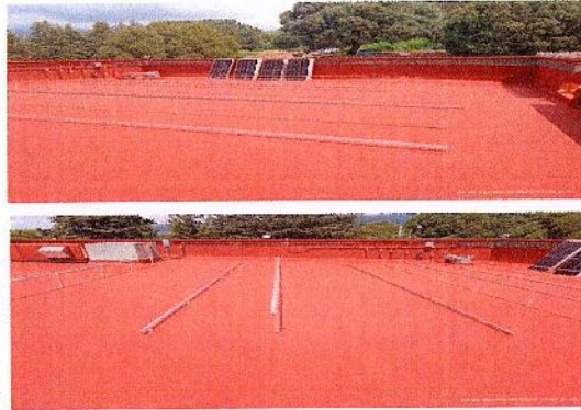
F24: Suministro y colocación de bases metálica para paneles solares en auditorio
