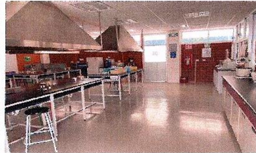
F2: Se equipará el Laboratorio Químico Para Docencia, con colocación e instalación de cerradura, tipo barra antipánico.
