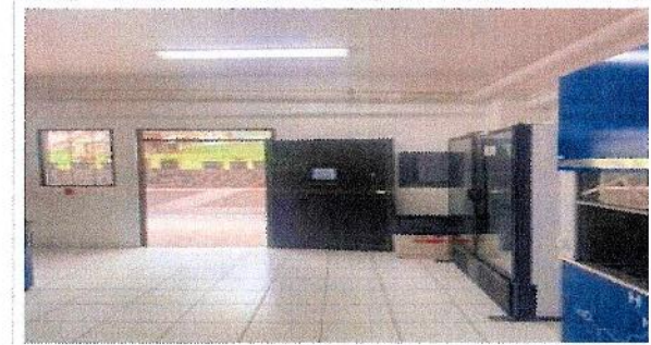
F5: Se equipará el Laboratorio B03 de la Facultad de Farmacia, con 1 extractor atmosférico y 2 anaquel metálico.
