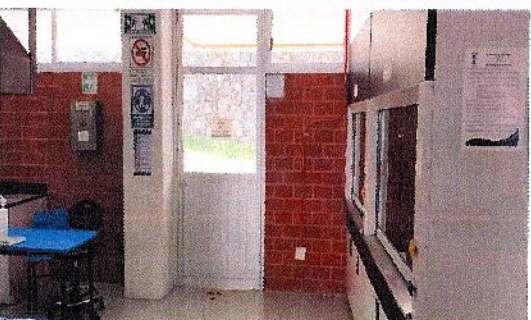
F22: Se equipará la puerta de salida de emergencia del Laboratorios LQ3, con colocación e instalación de cerradura, tipo barra antipánico.
