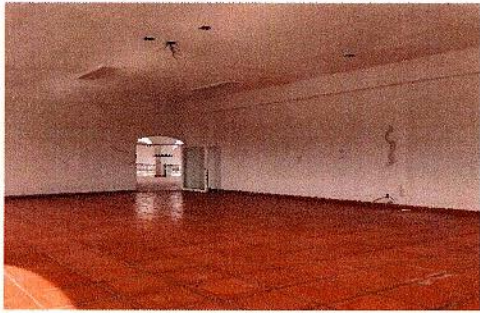
F6: Se equipará el Salón 5, con silla y mesa binaria.
