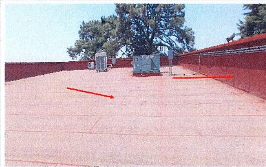
F3: Adecuación y Mejoras de la Cubierta y "Huerto Solar" en la Biblioteca Central. Trabajos de impermeabilización, en losa de azotea y perfil, colocación de sistema fotovoltaico (huerto solar) Área de auditorio
