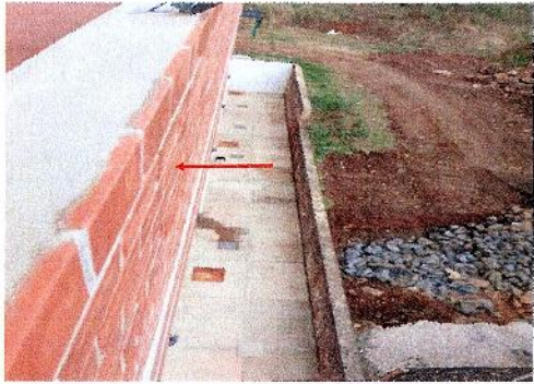
F6. Mantenimiento al sistema de impermeabilización existente del edificio No. A 70. Impermeabilización de Muros Exteriores, Fachada Este.
