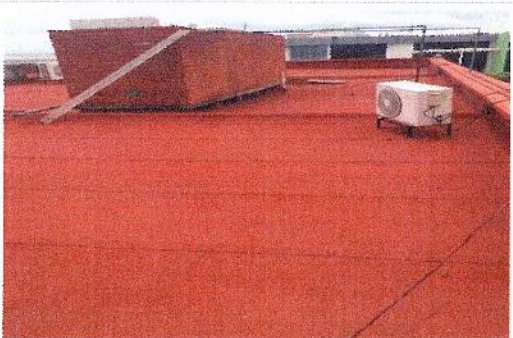
F3: Mantenimiento de impermeabilización en fosa del edificio del Centro de Investigación en Ciencias.
