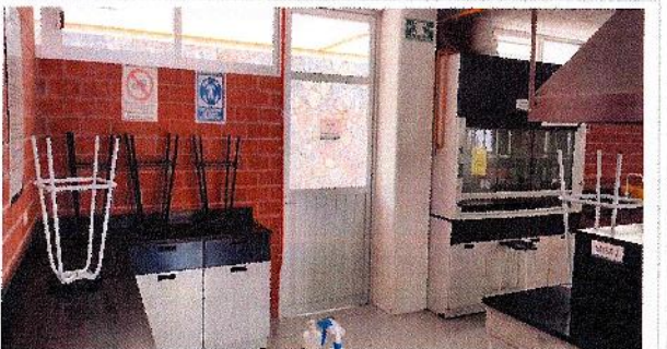
F23: Se equipará la puerta de salida de emergencia del Laboratorios LQ4, con colocación e instalación de cerradura, tipo barra antipánico.
