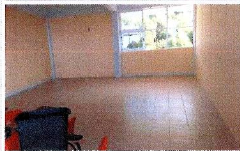
F4: Aula 3, 2do nivel edificio 71, con ventilador
