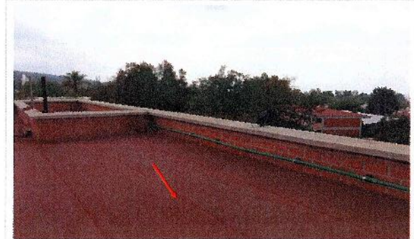
F5: Mantenimiento al sistema de impermeabilización existente del edificio No. A 70. Cubierta de azotea, fachada sur, del edificio.
