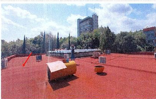
F4: Mantenimiento de impermeabilización en fosa del edificio del Centro de Investigación en Ciencias (CInC). Lado Sur del edificio.
