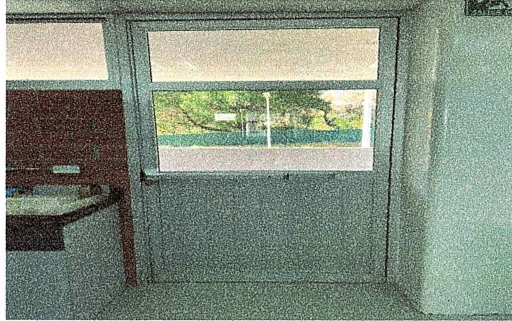
F6: LQ4, equipado con barra antipánico para puertas de salida.
