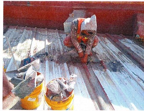
F5: Desprendimiento de impermeabilizante existente en juntas
