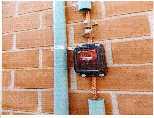
F68: Suministro y colocación de contador de descargas.
