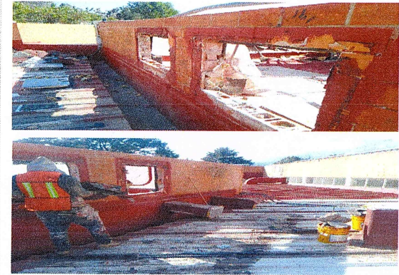
F6: Desprendimiento de impermeabilizante existente
