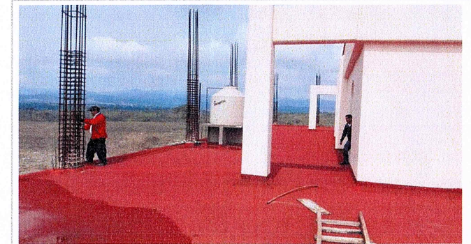
F1: Mantenimiento a impermeabilizante de azotea en Edificio Principal de la Escuela de Estudios Superiores de Mazatepec, Subside Tetecala.
