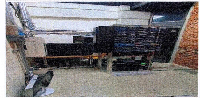
F7: Se equipará Centro de cómputo (SITE), con computadora, 2 Switches y 2 UPS's.
