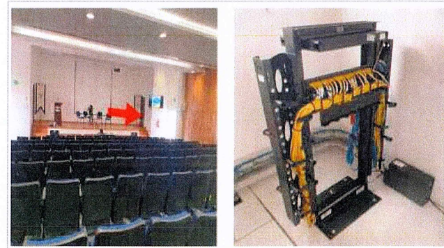
F4: Se equipará Auditorio, con 1 switch 48 puertos.
