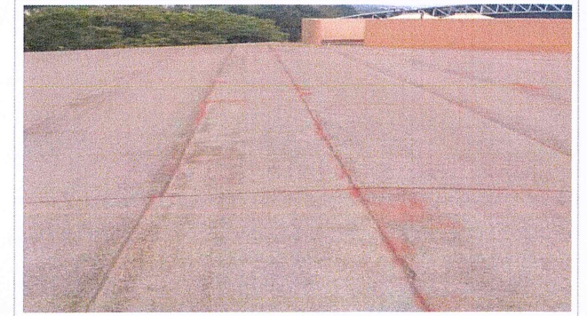
F1: Mantenimiento al sistema de Impermeabilización de azoteas en el edificio Principal de la Estación Biológica el Limón, adscrita al CIByC.
