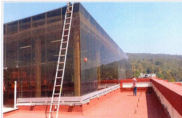
F1: Mantenimiento al sistema de impermeabilizante en azotea del edificio A-57 del Centro de Investigación en Biotecnología (CEIB).
