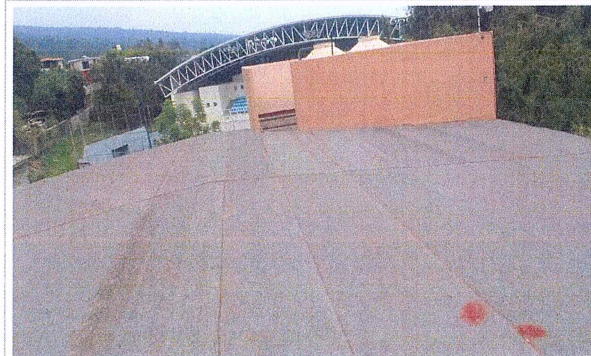
F2: Mantenimiento a Impermeabilizante de azoteas de los edificios A-66 y A-67 de la Facultad de Ciencias del Deporte.
