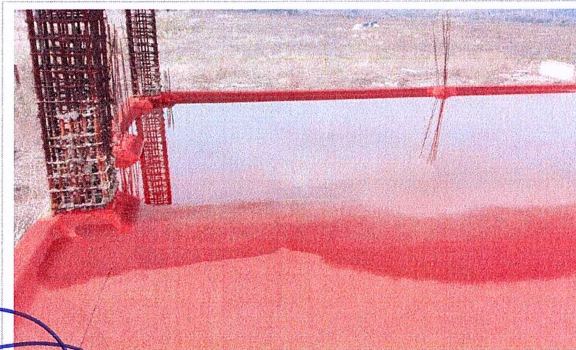
F1: Mantenimiento a impermeabilizante de azotea en Edificio Principal de la Escuela de Estudios Superiores de Mazatepec, Subside Tetecala.
