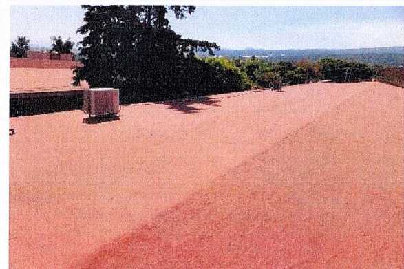
F1: Mantenimiento al sistema de impermeabilizante en azoteas de los edificios A-24 de la Facultad de Derecho y Ciencias Sociales.
