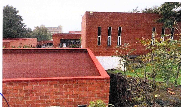
F2: Mantenimiento a sistema de impermeabilizante en losa de azotea y muros de los edificios A-59b de la Facultad de Artes.
