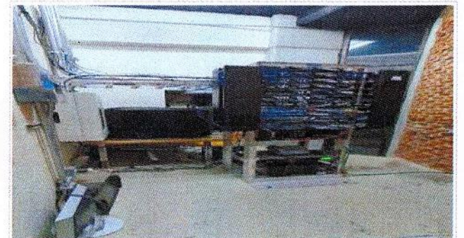
F7: Se equipará Centro de cómputo (SITE), con computadora, 2 Switches y 2 UPS's.
