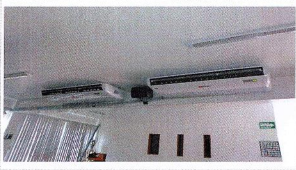
F4: Auditorio, equipado con aires acondicionados, 2 piezas.
