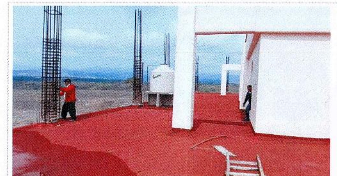
F1: Mantenimiento a impermeabilizante de azotea en Edificio Principal de la Escuela de Estudios Superiores de Mazatepec, Subsede Tetecala.
