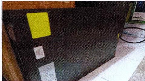
F1: Biblioteca (Centro de cómputo) equipado, con 2 UPS's.
