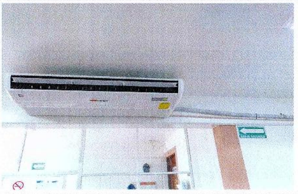
F4: Centro de Cómputo, equipado con aire acondicionado, 1 pieza.
