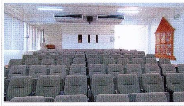
F4: Auditorio, equipado con aires acondicionados, 2 piezas.
