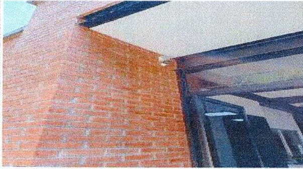
F10: CIB (Aula 1, Aula 2, Aula 3, Laboratorio de posgrado y Biblioteca / Centro de cómputo) equipado con 1 Sistema de seguridad.
