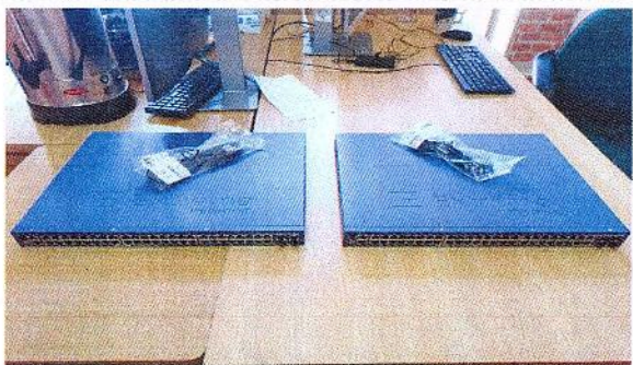
F7: 2 Switches X440-G2 para Centro de cómputo (SITE).
