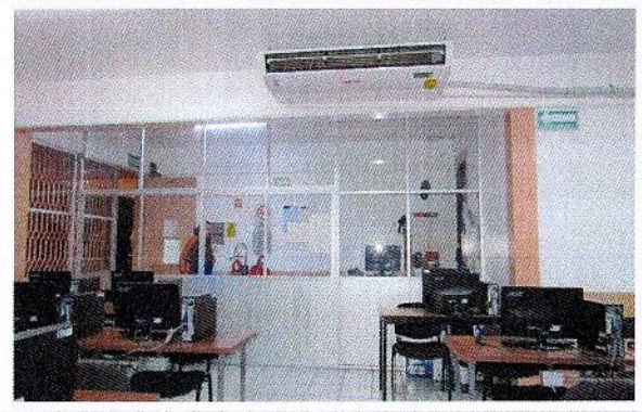
F5: Centro de Cómputo, equipado con aire acondicionado, 1 pieza.
