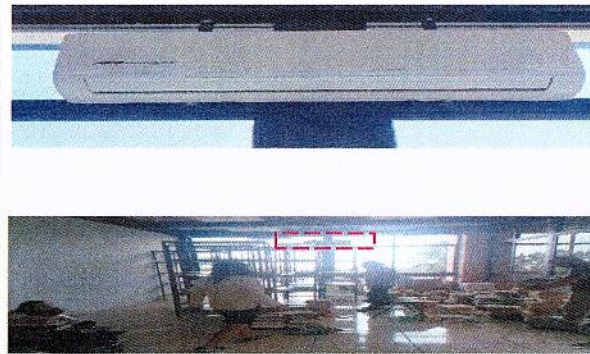
F7: Biblioteca/Centro de cómputo equipado, con 1 aire acondicionado.
