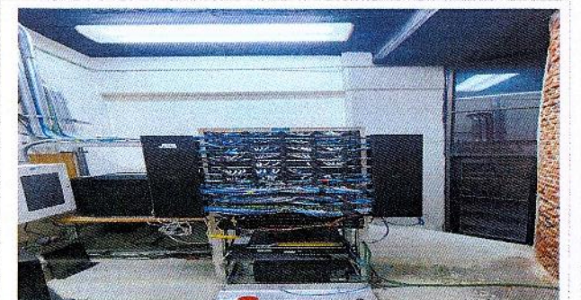
F7: Se instalaron 2 Switches X440-G2 en Centro de cómputo (SITE).
