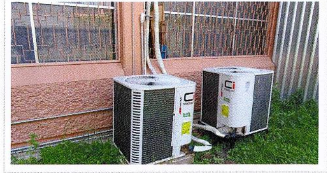
F4: Auditorio, equipado con aires acondicionados, 2 piezas.
