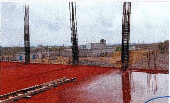
F1: Mantenimiento a impermeabilizante de azotea en Edificio Principal de la Escuela de Estudios Superiores de Mazatepec, Subsede Tetecala.
