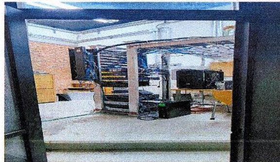
F7: Se instalaron 2 Switches X440-G2 en Centro de cómputo (SITE).
