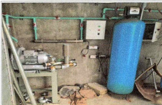
Trabajos de suministro, instalación y puesta en funcionamiento de sistema de clorado, en la Facultad de Contaduría, Administración e Informática.
