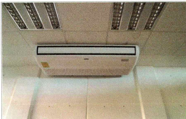
Aire acondicionado instalado en el centro de cómputo del Centro Interdisciplinario de Investigación en Humanidades (CIHu)
