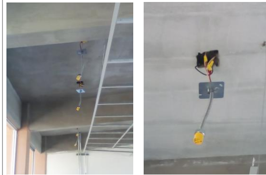
F4: Cableado eléctrico para luminarias
