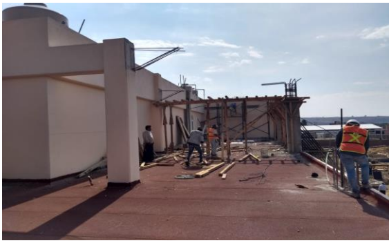
F17: Habilitado de cimbra puente para traves en ampliación del segundo nivel
