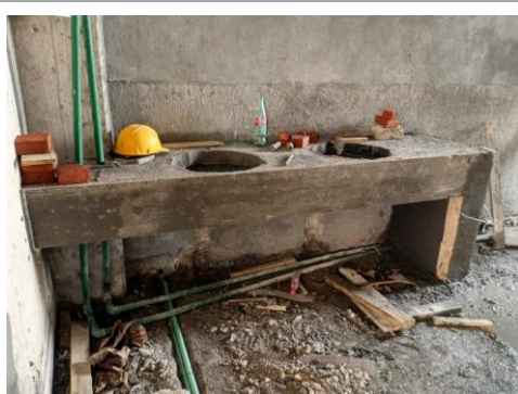
F13: Colado con concreto hecho en obra de mesetas para lavabos en sanitarios
