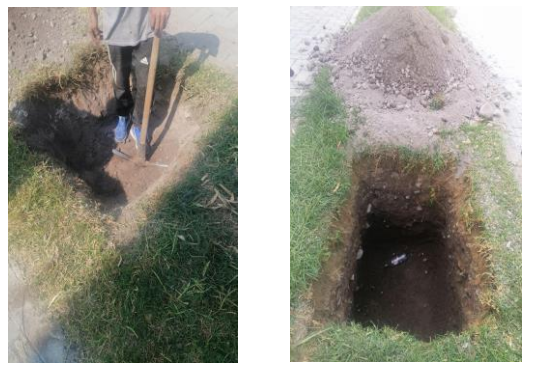
F4: Excavación de terreno para realizar dados para colocación de postes de luminarias en estacionamiento
