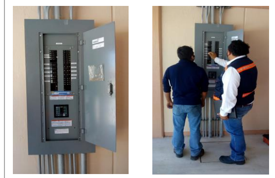
F19: Identificación de circuitos en tablero de planta baja
