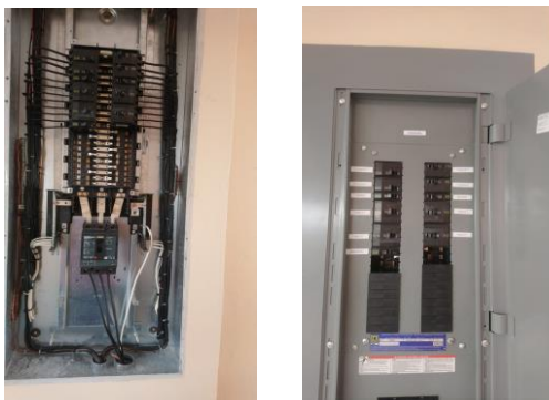
F18: Identificación de circuitos en tablero de planta alta
