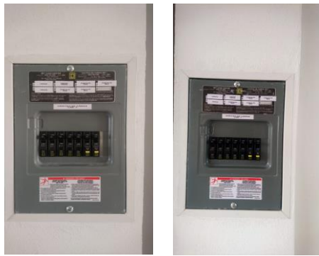
F17: Identificación de circuitos en tableros de laboratorios
