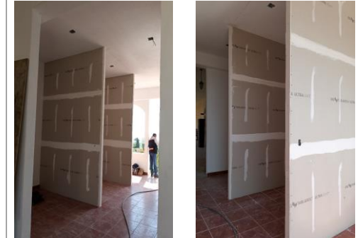
F32: Elaboración de muros de tablaroca dos caras en divisiones de cubículos
