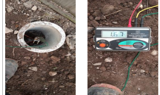
F22: Sistema de tierras para protección de site (medición)
