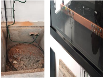
F23: Sistema de tierra para protección de site (cableado a barra de cobre)
