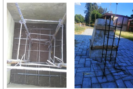
F5: Habilitado de acero para dados de concreto para colocación de postes de luminarias en estacionamiento
