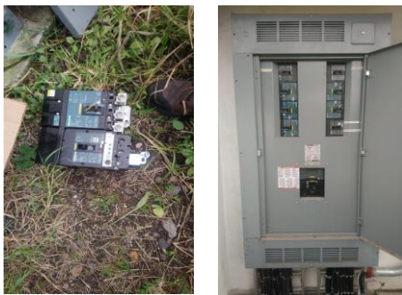
F20: Colocación de interruptor termomagnético en tablero general para alimentación de edificio de laboratorios
