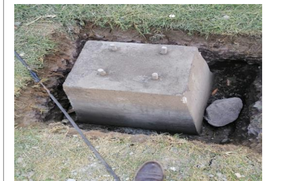
F31: Descimbrado de dados de concreto para colocación de postes de luminarias en estacionamiento
