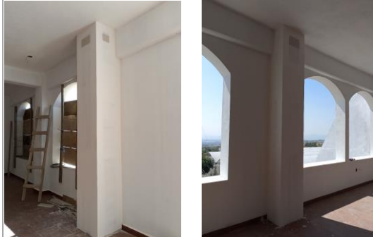
F31: Elaboración de cajillos de tablaroca para cubrir tuberías de bajadas pluviales
