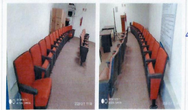
F31: Butacas para auditorio instaladas a un costado izquierdo de auditorio.
