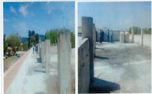
F3: Estado en que estaba la Planta Alta.
