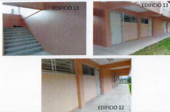
F10: Se colocaran extintores en Edificio 12 y 13.
