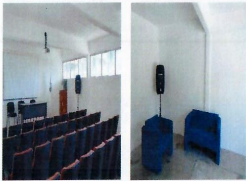
F31: Instalación de Baffles en Sala Audiovisual y espacio de Cabina de radio y televisión.
