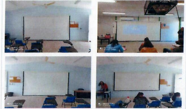
F36: Proyectores instalados y en funcionamiento.
