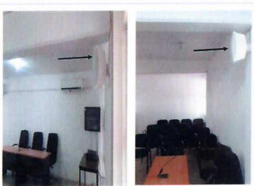
F6: Bocinas instaladas en Sala de Juicios Orales.
