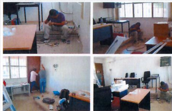
F4: Instalación de microfonos en Sala de Juicios Orles.
