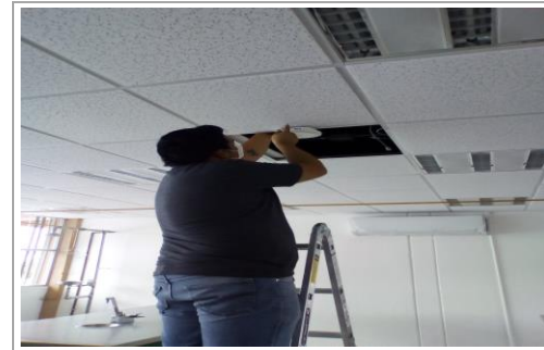
F14: Colocación de access point en cada laboratorio
