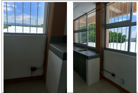
F40: Salidas eléctricas para contactos trifásicos
