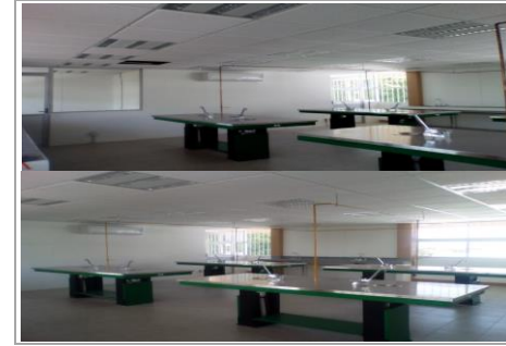
F32: Instalación de gas en mesas de laboratorio
