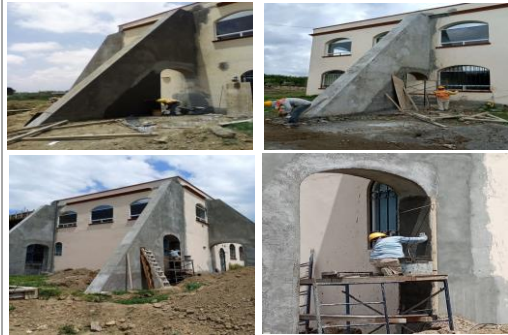
F19: Aplanado fino en muro de block y arco de concreto en contrafuerte
