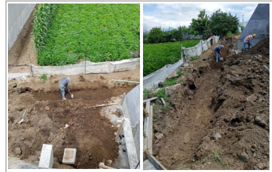
F32: Excavación de terreno por medios manuales para tendido de tubería de pvc pesado para cableado de voz y datos
