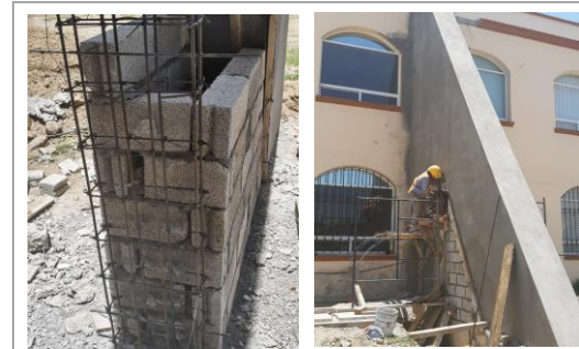
F5: Elaboración de muro de block para base de arco en contrafuerte
