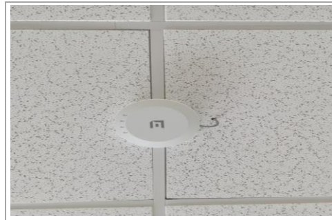
F25: Colocación de access point en cada laboratorio
