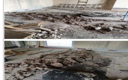
F35: Demolición de entortado existente para dar nivel de piso terminado en el interior de la ampliación de la planta alta
