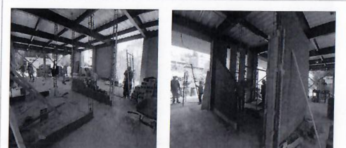
F53: Construcción de muros interiores de tabique rojo recocido en planta baja.
