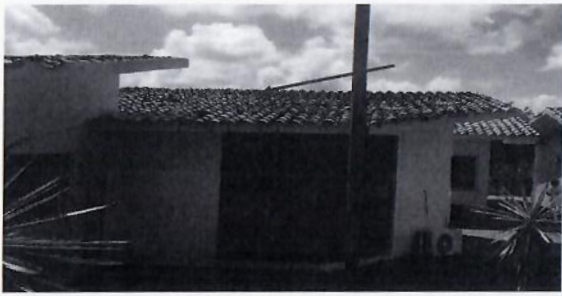
F6: Retiro de teja, chafanes e impermeabilizante en losa, suministro y colocación de impermeabilizante, teja, fabricación de chaflán. Edificio 06.
