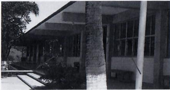
F1: Desmontaje de ventanas, suministro y colocación de cancelería de aluminio, desmontaje de puertas, suministro, armado y colocación de multy-puerta. Edificio 2
