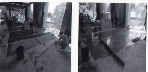
F55: Colado de firme de concreto hecho en obra en planta baja.
