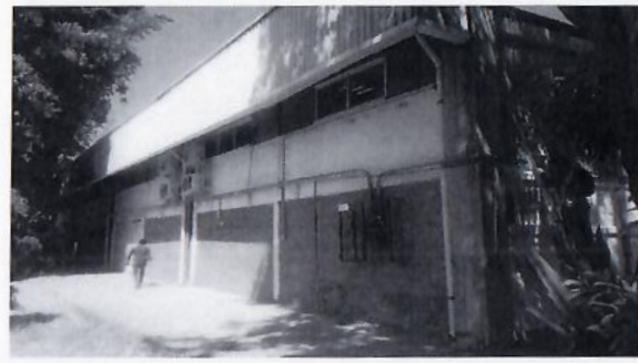
F2: Adecuación a la salida de emergencia suministrando barra antipánico que funcionen y rehabilitando las puertas.
