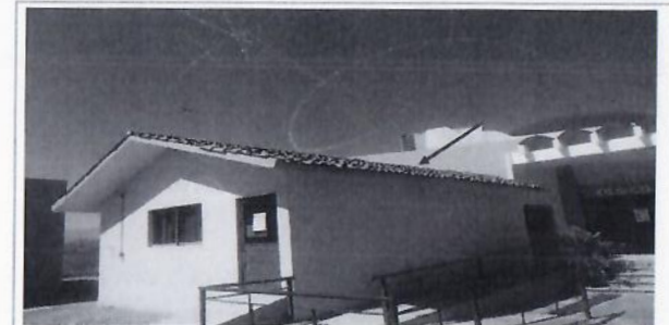
F5: Retiro de teja, chaffanes e impermeabilizante en losa, suministro y colocación de impermeabilizante, teja, fabricación de chaffán. Edificio 06
