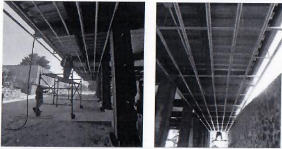
F48: Colocación de canal listón para soporte de plafón de durock en pasillo de planta baja.
