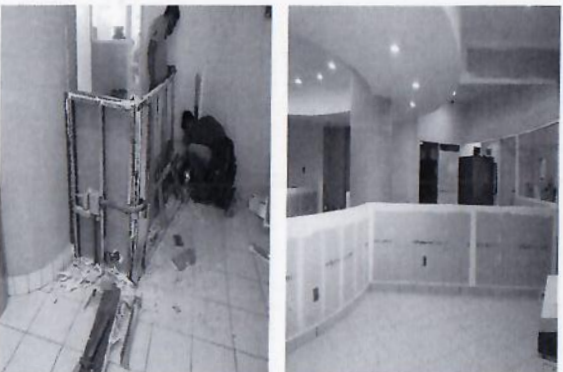
F8: Desmontaje y adecuación de líneas de voz y datos y contactos.
