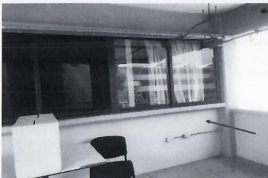
F3: Demolición de muro, desmantelamiento de ventana, suministro y colocación de puerta de emergencia
