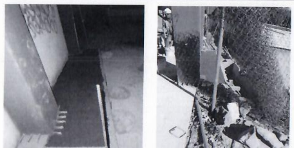
F37: Colado de firme con concreto hecho en obra en salientes para muros planta baja.
