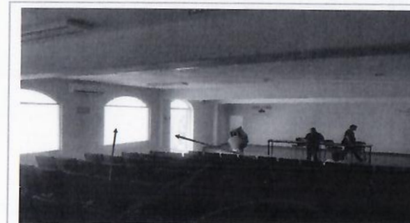
F5: Suministro y colocación de protecciones de herrera y puerta de emergencia.
