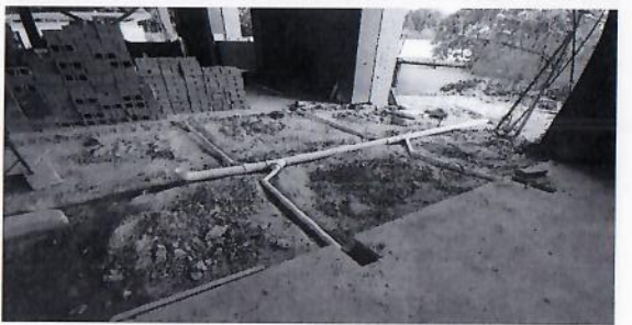
F54: Colocación de tubería de pvc para instalación sanitaria en planta baja.
