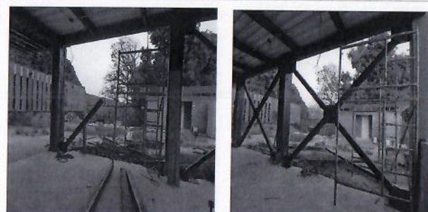
F46: Cambio de contraventes en planta baja de acuerdo al dictamen estructural presentado por el D.R.O.
