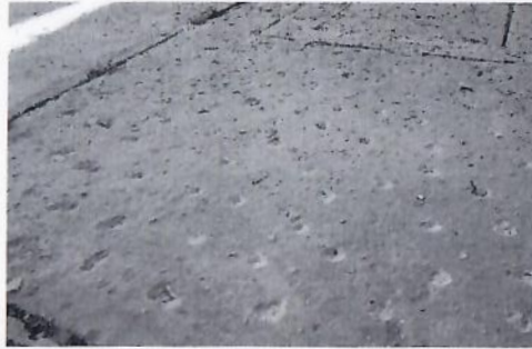
F9: Picoteo en piso de concreto con maceta y cincel en explanada.
