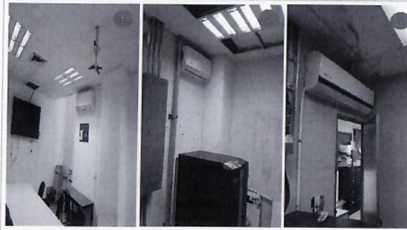
F2: Se colocó aire acondicionado en Sala de juntas, Cluser y Cuarto de cómputo UPS 1
