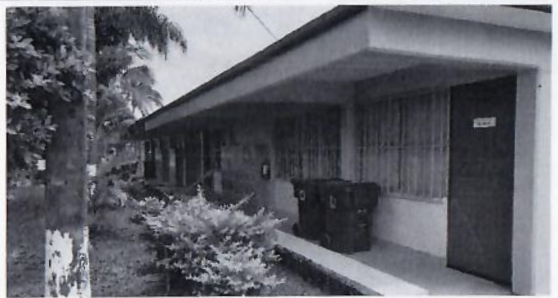
F3: Desmontaje de ventanas, suministro y colocación de cancelería de aluminio, desmontaje de puertas, suministro, armado y colocación de multy-puerta y puerta de emergencia en sala de juicios orales y auditorio. Edificio 3
