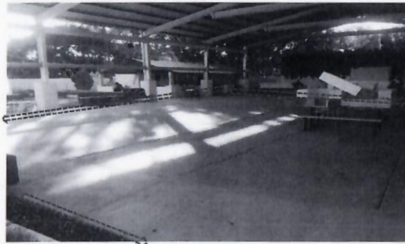
F2: Trazo, picoteo de concreto, Fabricación de firme de concreto, corte con disco y calafateo. Plaza Cívica.
