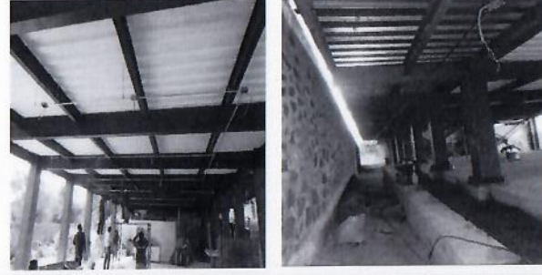
F25: Tendido de tubería conduit y cableado para instalación eléctrica en planta baja.
