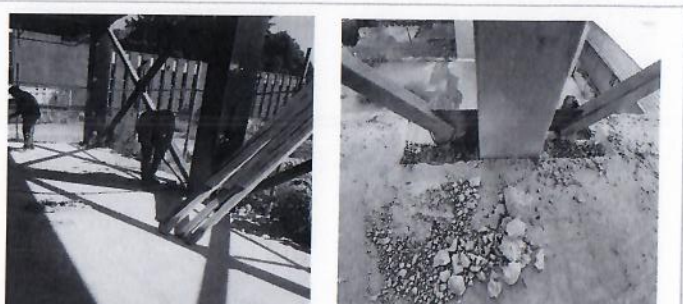
F38: Demolición de firme alrededor de columnas para colocación de ángulos de refuerzo y cambio de contraventeos en planta baja y demolición de losa de entrepiso para cambio de contraventeos primer nivel.
