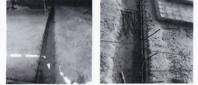
F65: Habilitado de acero para cadena de desplante de muros en planta baja.
