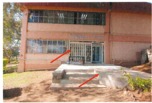
F22: Puerta protección de herrería y firme de concreto en acceso principal a Edificio 13.
