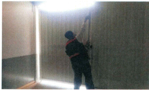
F1: Adecuación a la salida de emergencia suministrando barra antipánico que funcionen y rehabilitando las puertas.
