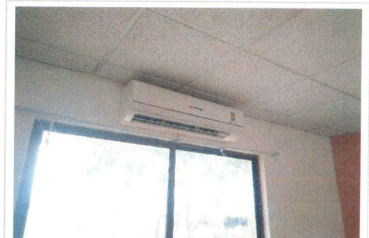
F26: Mantenimiento preventivo a unidades de refrigeración
