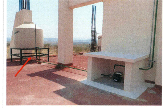
F16: Conexión de tinaco a presurizador con base de herrena.
