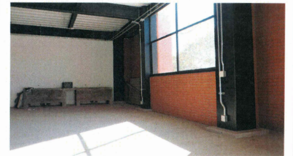
F38: Instalación eléctrica en el edificio.
