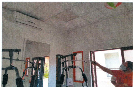
F25: Mantenimiento preventivo a unidades de refrigeración
