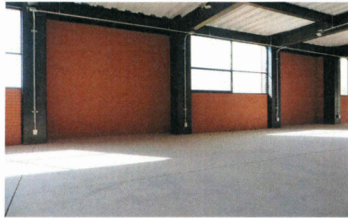
F34: Instalación eléctrica en el edificio.
