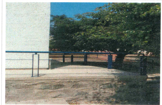
F6: Colocación de barandal de herrera con aplicación de pintura a rampa de acceso a vestíbulo de auditorio.
