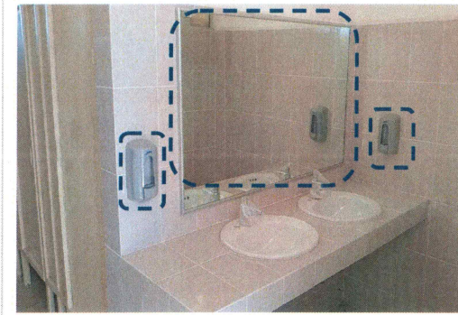
F10: Adecuación de modulo de sanitarios, suministro y colocación de jaboneras en muros de barra da lavabos y espejos.
