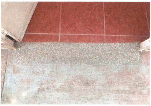
F8: Colado de cenefa de concreto deslavado en acceso de puertas a aulas por cambio de nivel.
