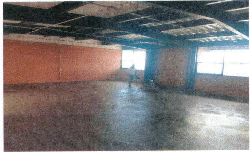
F15: Acabado pulido de firmes de concreto premezclado en interior de aulas
