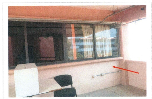
F3: Demolición de muro, desmantelamiento de ventana, suministro y colocación de puerta de emergencia
