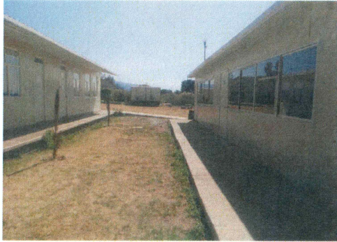
F1: Fachadas de edificios donde se realizarán los trabajos - Escuela de Estudios Superiores de Tototapan.
