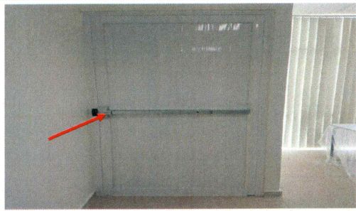
F5: Suministro y colocación de puerta de aluminio blanco con barra antipánico para salida de emergencia.
