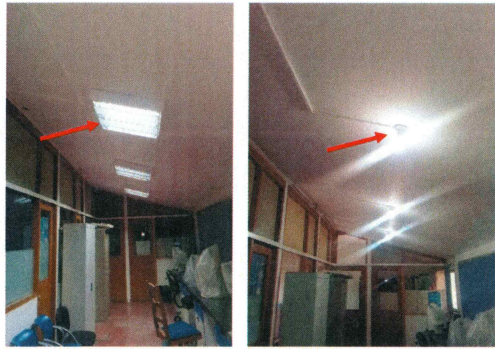
F5: Sustitución de lámparas interiores.
