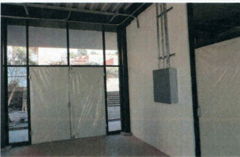
F39: Instalación eléctrica Analisis de voz y datos
