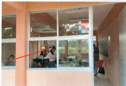
F4: Aula tipo, en area de ventana de aluminio se colocara proteccion de herrería.
