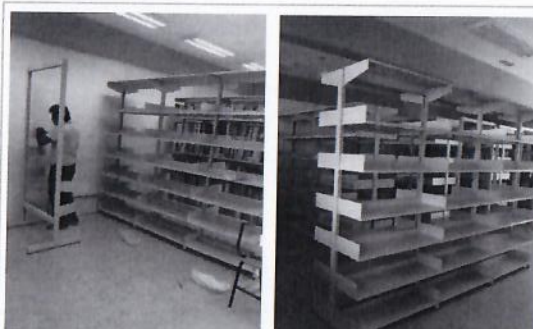
F7: 9 modulos de Estanteria bibliotecaria con 6 entrepaños, salon E y F planta baja edificio C
