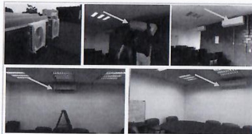
F3: Se coloco sistema de aire acondicionado en Sistemas Digitales y Salón de seminarios.
