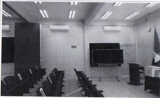
F3: Se colocaron cinco sistemas de aire acondicionado en Auditorio (Edificio 72)
