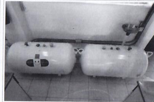
F5: Se adquirieron dos tanques estacionarios de Gas LP con capacidad de 300 cúb.
