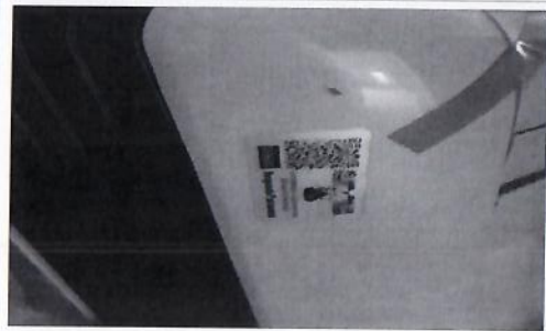
F3: Edificio 6 Aire Acondicionado para el Centro de Computo
