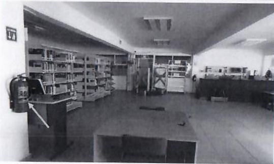
F12: Extintor en biblioteca
