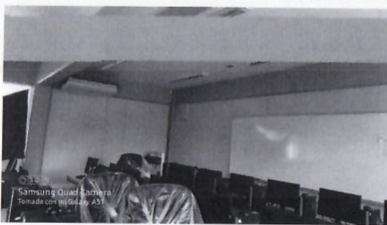
F4: SISTEMA DE AIRE ACONDICIONADO: 1 SISTEMA DE AIRE ACONDICIONADO: Se colocó en el Edificio de Talleres en el Centro de Computo
