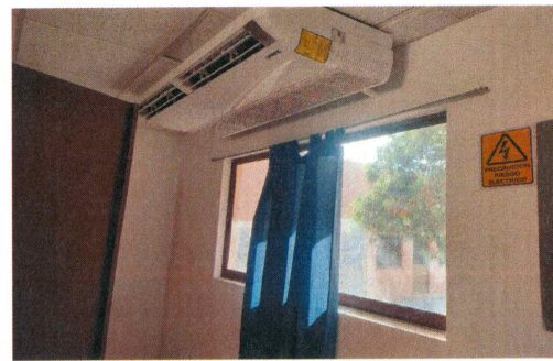
F28: 1 AIRE ACONDICIONADO DE 5.0 TR AULA 11 EDIF 03
