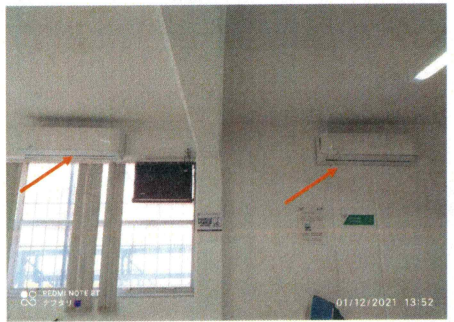
F18: 2 Sistemas de Aire Acondicionado de 2 Toneladas se ubicarán en el Centro de Computo del Edificio C Planta Baja.
