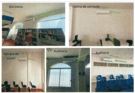
F4: Se ubica 1 Aire Acondicionado de 2 TR. en la Camara de Gesell, 1 Aire Acondicionado en la Biblioteca, 1 Aire Acondicionado en el Centro de Computo y 2 en el Auditorio de la EESMazatepec Subsede Miacatlán.
