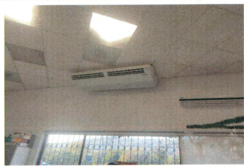
F27: 1 AIRE ACONDICIONADO DE 5.0TR EN SERVICIOS ESCOLARES
