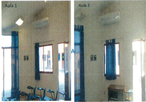
F24: 1 AIRE ACONDICIONADO EN AULA 1 y 2 DEL EDIF 06
