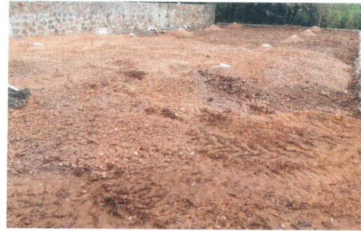
22.- Suministro y tendido de material de banco por medios mecánicos (Almacén de residuos).
