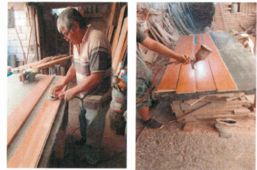
22.- Reparación de piso de duela en taller para posterior colocación en estrado de auditorio.
