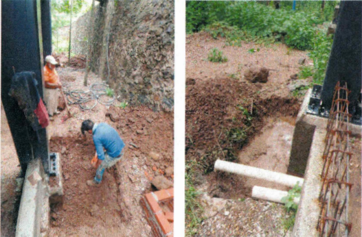
55.- Excavación de terreno por medios manuales en columnas para descubrir zapatas (Edificio CIB).
