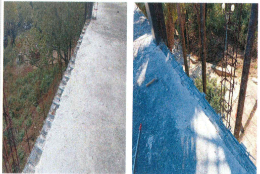
78.- Demolición de losa de concreto existente para anclaje de volados (Edificio CIB).
