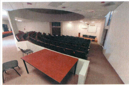
F9: 2 PROYECTORES DE TIRO LARGO EN AUDITORIO EDIF. 03
