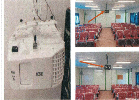
F29: 1 Proyector inatambrico se ubicará en el Aula 11 del Modulo 1 de Aulas móviles.
