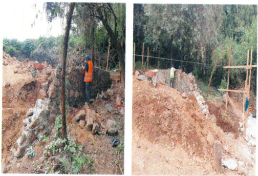
18.- Elaboración de muro de mampostería de piedra de sitio (Almacén de residuos).
