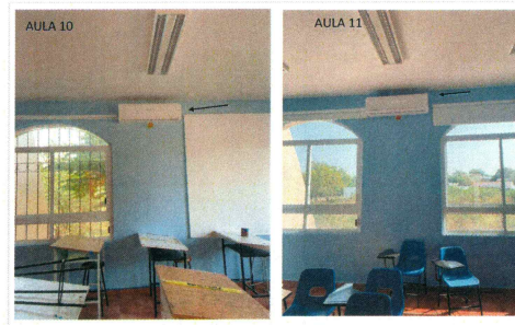
F6: Se ubicará Aires Acondicionados de 1.5 Tr. en el Aula 10 y 11
