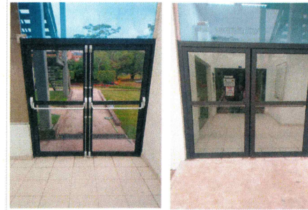
14.- Suministro y colocación de puerta de aluminio con barra antipánico de emergencia.
