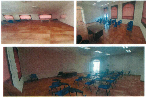
F6: Se ubicaron 3 aires acondicionados de 2 tr. en la AULA 5, AULA 6 y AULA 7 de la EES Mazatepec subsede Tetecala.
