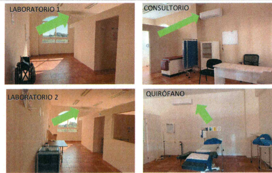
F9: Se ubicaron 4 aires acondicionados de 1.5 T.R en el consultorio, quirófano y en los laboratorios de enfermería 1 y 2 de la EES Mazatepec Subsede Tetecala.
