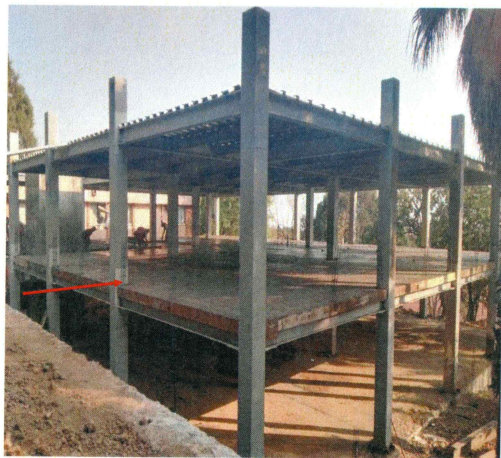
1.- Fachada Norte y Oeste - Construcción de la segunda etapa para la ampliación de laboratorios, cubículos de investigación, y oficinas académicas para el Centro de Investigaciones Biológicas antes CEIB [etapa final].
