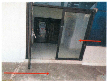
3.- Suministro y colocación de puerta de aluminio, barra antipánico y rampa de concreto
