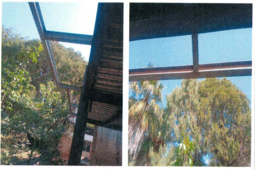
81.- Suministro y colocación de estructura metálica para volados de losa (Edificio CIB).
