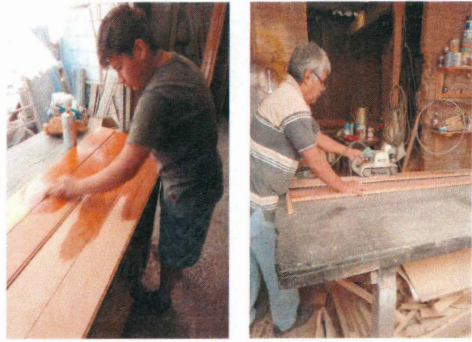
24.- Reparación de piso de duela en taller para posterior colocación en estrado de aviliterio.
