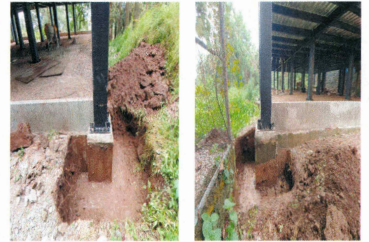
56.- Excavación de terreno por medios manuales en columnas para descubrir zapatas (Edificio CIB).
