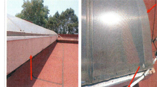
5.- Remates perimetrales de perfil de aluminio, sujeción del perfil de aluminio con monten base y placas de remate de policarbonato.
