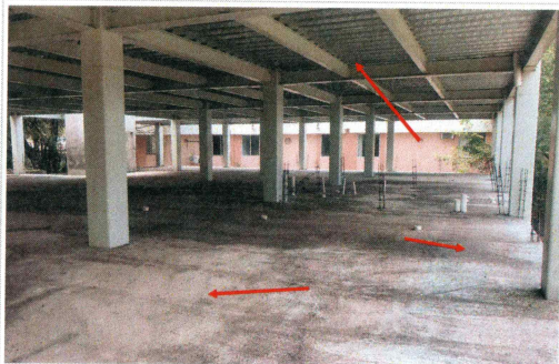
3- Planta Baja - Se desarrollaran trabajos de construcción de cadena perimetral y firme de concreto, colocación de loseta de cerámica, muros divisorios de tablaroca, colocación de plafón, instalaciones, cancelería.
