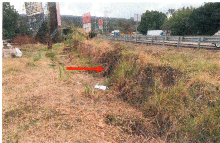
3.- Vista interior rea perimetral: retiro de malla existente deteriorada, deshierbe y limpieza del área, excavación y construcción de rodapié de mampostería de piedra, colocación de malla ciclónica con postes metálicos.
