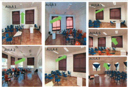
F8: Se ubicaron 7 aires acondicionados de 2 T.R en las aulas 1, aula 2, aula 3, aula 4, aula 5, aula 6 y aula 7 de la EES Mazatepec Subsede Tetecala.
