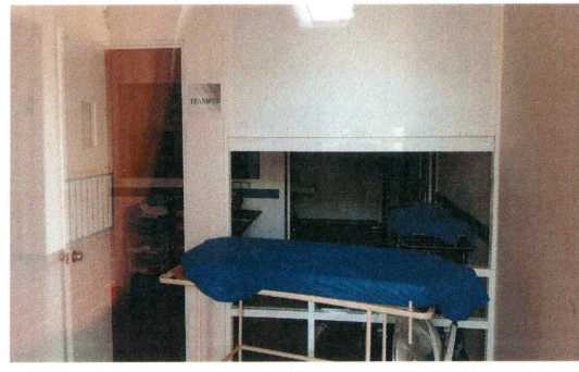
F7: Se ubicaron 1 aire acondicionado de 2 tr. en el quirófano de la EES Mazatepec Subsede Tetecala.
