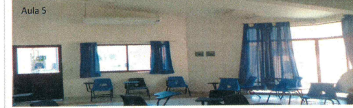
F26: 1 AIRE ACONDICIONADO EN AULA 3, 4 Y 5 DEL EDIF 07
