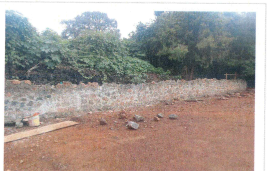
20.- Elaboración de muro de mampostería de piedra de sitio (Almacén de residuos).
