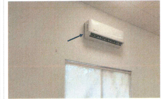
F59: 1 AIRE ACONDICIONADO 2 T.R. AULA DE ATENCION DE PSICOLOGIA EDIF 01
