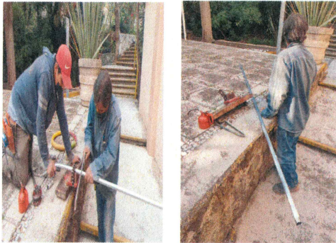
9.- Alimentación eléctrica para bombas de agua
