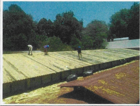
F6: Techo TAMULBA: retiro de material de espuma de poliuretano existente en mal estado, sobre cubierta metálica del edificio
