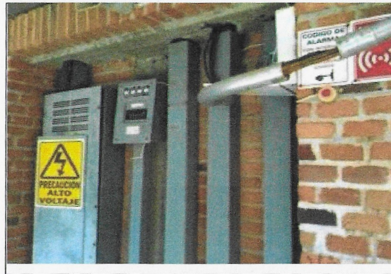
F2: Instalaciones Eléctricas
