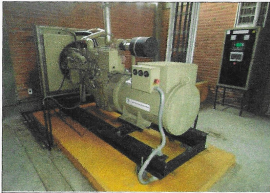
F1: Planta de emergencia
