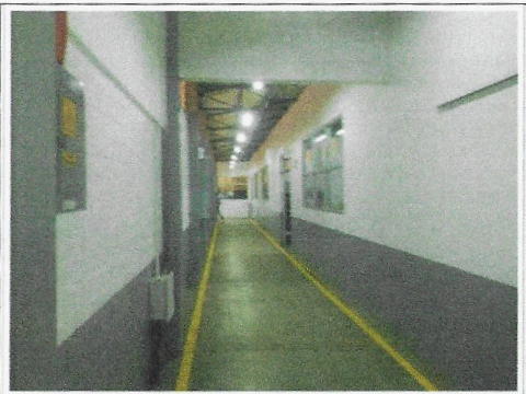
F14: TAMULBA-FCQel: Trabajos concluidos de aplicación de pintura vinílica y de esmalte en muros de pasillos interiores.
