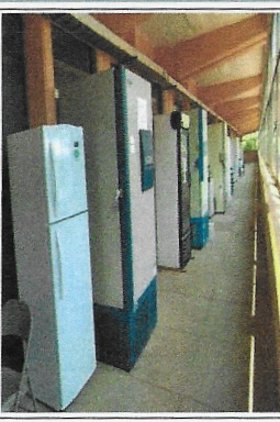
F5: Equipos de refrigeración y aires acondicionados.
