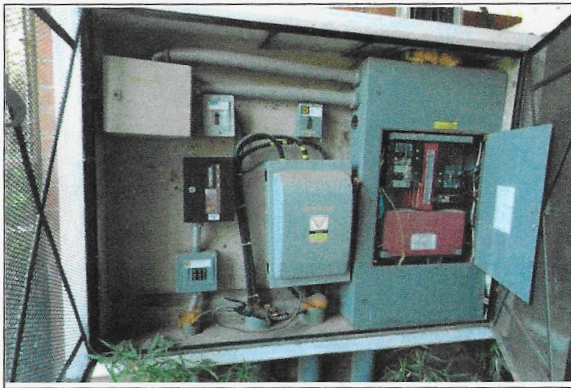
F2: Conductores eléctricos
