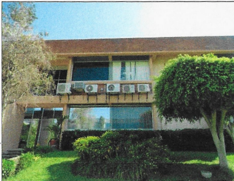
F3: Aires acondicionados
