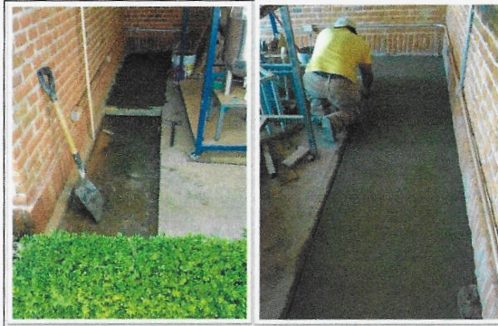
F7: Interior de aula (laboratorio) quitar adocreto, para colocar concreto acabado pulido y rayado [foto izquierda]. Acabado al concreto ya terminado [foto derecha].
