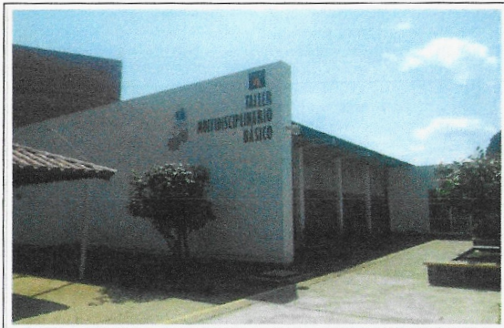
F15: TAMULBA-FCQel: Trabajos terminados de aplicación de pintura vinílica en muros de fachada principal así como de pintura de esmalte en estructura y puertas metálicas.
