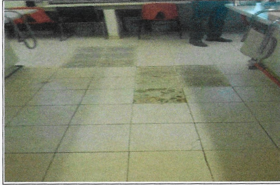
F8: Piso de laboratorio dañado
