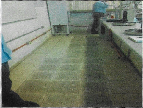
F7: Piso de laboratorio dañado
