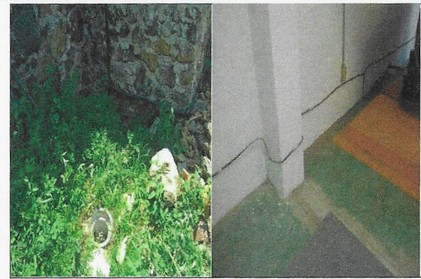
F2: Sistema de tierras físicas
