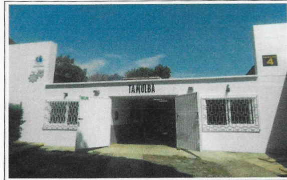
F16: TAMULBA-FCQel: Trabajos terminados de aplicación de pintura vinílica en muro y pintura de esmalte en puertas y protecciones de ventana.
