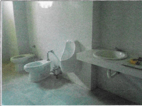
F12: Azulejo, piso, sanitarios con fluxómetro de pedal, mingitorio ecológico y barra con obalinos, todo nuevo y terminado (hombres)
