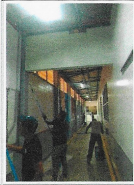
F8: TAMULBA: Aplicación de pintura vinílica y de esmalte en muros interiores de edificio
