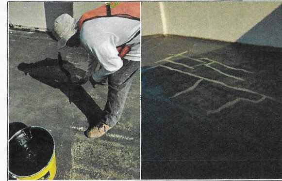
F5: Techo del edificio: Vista de los trabajos de calafateo en grietas de losa
