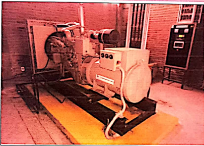
F1: Planta de emergencia
