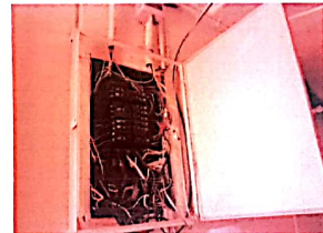
F5: Cableado Eléctrico
