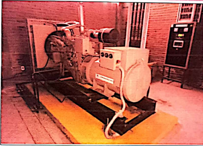
F1: Planta de emergencia
