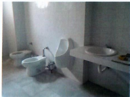
F15: Azulejo, piso, sanitarios con fluxómetro de pedal, mingitorio ecológico y barra con obalines, todo nuevo (hombres)
