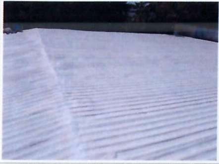
F25: Imagen de los trabajos terminados de aplicación de impermeabilizante de espuma de poliuretano con acabado final sobre cubierta metálica del edificio LOU.
