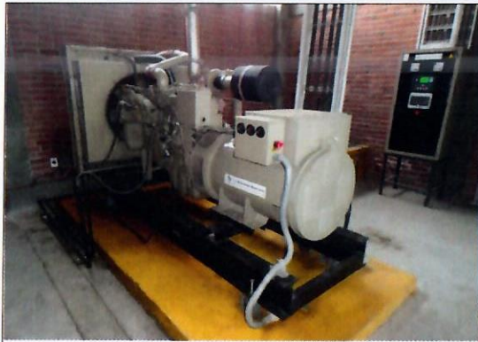
F1: Planta de emergencia
