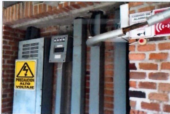
F2: Instalaciones Eléctricas
