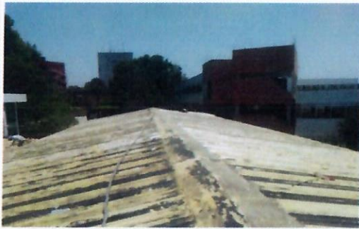
F7: Techo TAMULBA: Retiro de material deteriorado sobre laminas metálicas y cumbre de cubierta, lado sur de edificio
