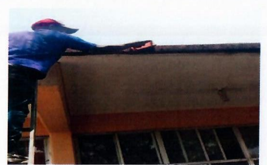
F19: Vista de los trabajos de preparación de la superficie para suministro y aplicación de pintura vinilica acrílica edificio 4 y 3
