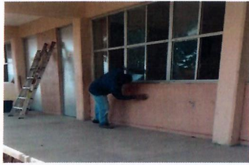
F15: Vista de los trabajos de preparación de la superficie para suministro y aplicación de pintura vinilica acrílica edificio 4 y 3
