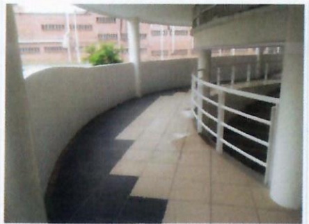
F33: Aplicación de Pintura de esmalte en barandales de herrería y columnas metálicas de vestibulo principal, área de laboratorios edificio 35 FCQel
