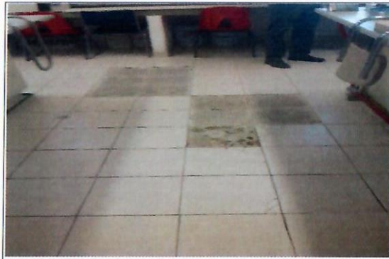
F8: Piso de laboratorio dañado
