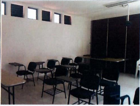
F9: Pintura vinilica (salones)
