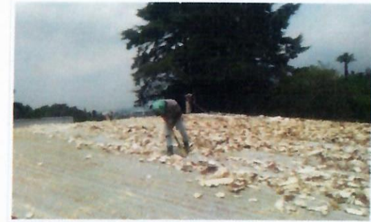
F17: Imagen de los trabajos de limpieza de láminas traslucidas existentes en cubierta metálica de LOU.
