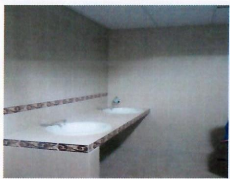
F11: Sanitarios: suministro y colocación de piso, azulejo, sanitarios, mingitorio ecológico (baño hombres)
