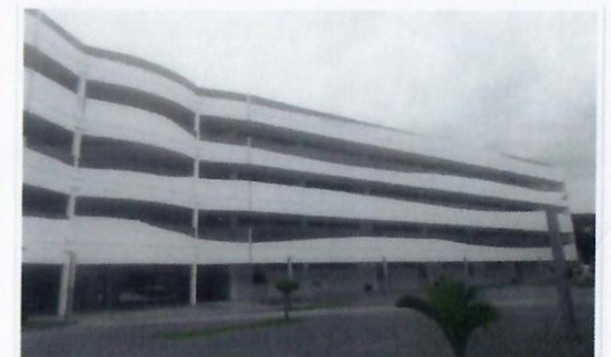
F38: Imagen de los trabajos de terminados de aplicación de pintura vinílica en muretes y faldón así como sellador en fachaletas de cerámica esmaltada de fachada principal edificio 35 FCQel.
