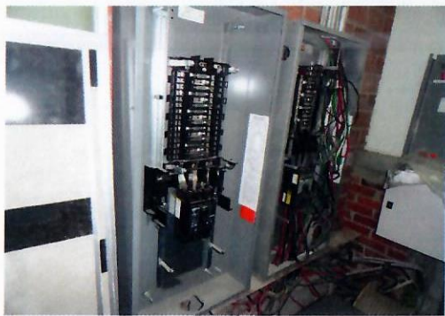
F1: Tableros eléctricos actuales
