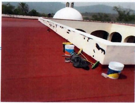
F17: Suministro y aplicación de impermeabilizante acrílico en azotea de segundo nivel del edificio
