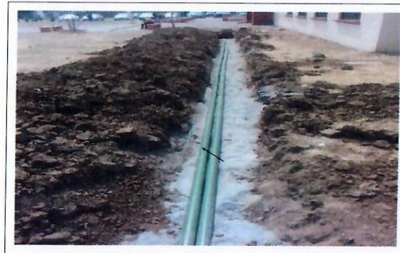
F8: Alimentador eléctrico de las dos cisternas
