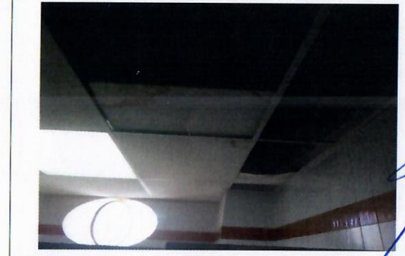
F5: Techo (Plafón)
