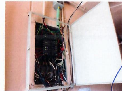
F5: Cableado Eléctrico
