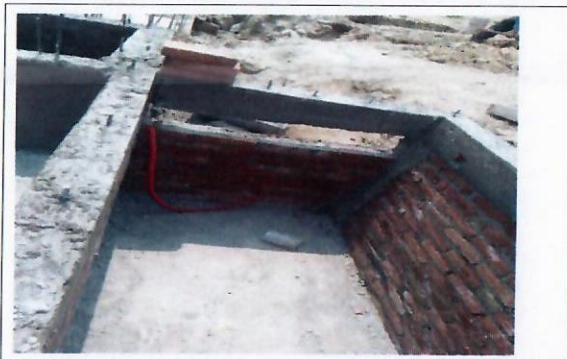
F11: Trabajos en el carcamo seco y paso de las dos cisternas
