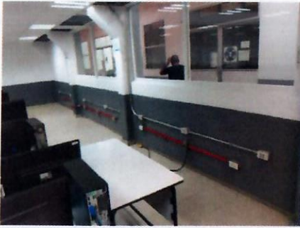
F24: TAMULBA-FCQel: trabajos de aplicación de pintura de esmalte en parte baja de muros así como en tuberías de instalaciones con diámetros variados.
