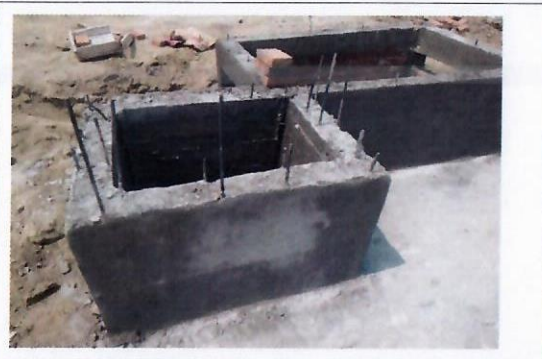
F10: Trabajos en el carcamo seco y paso de las dos cisternas
