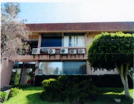
F3: Aires acondicionados
