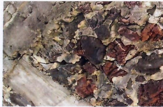
F2: Muro de contención que soporta el muro de colindancia dañado, con diferentes fisuras
