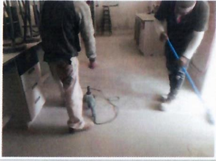
F17: Imagen de retiro de residuos previo a los trabajos de aplicación de pintura epóxica en piso de laboratorio, primer nivel lado sur de edificio 35 FCQel.
