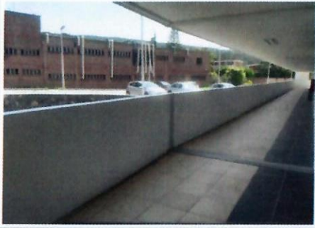
F30: Aplicación de pintura vinílica en pretiles y muros de pasillos principales, área exterior norte de laboratorios de primer nivel, edificio 35 FCQel.
