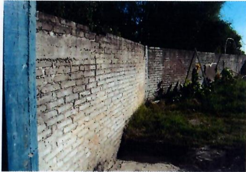
F1: Muro dañado
