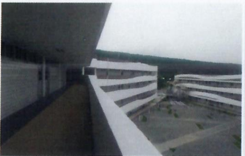
F37: Imagen de los trabajos terminados de aplicación de pintura vinílica en pretiles y muros, vestibulo principal de tercer nivel edificio 35.
