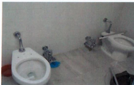
F16: azulejo, piso y sanitarios con fluxómetro de pedal nuevo (mujeres)
