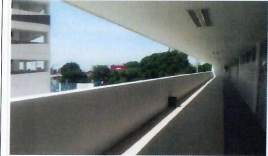
F32: Vista general de los trabajos terminados de aplicación de pintura vinílica en muretes de pasillos principales, área exterior sur de laboratorios edificio 35 FCQel.
