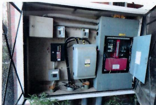
F2: Conductores eléctricos
