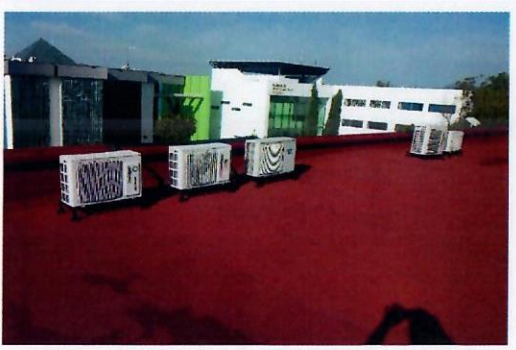
F12: cambio de lugar y mantenimiento de los aires
