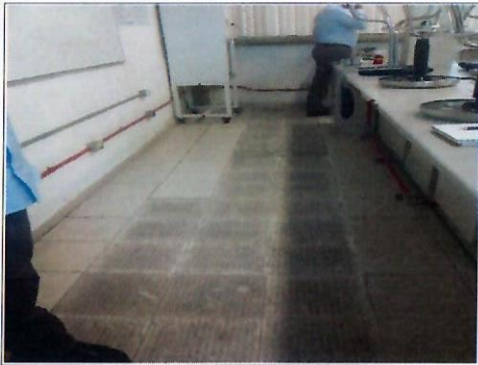
F7: Piso de laboratorio dañado
