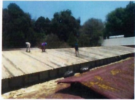
F6: Techo TAMULBA: retiro de material de espuma de poliuretano existente en mal estado, sobre cubierta metálica del edificio
