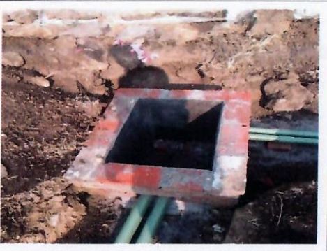
F9: Alimentador eléctrico de las dos cisternas
