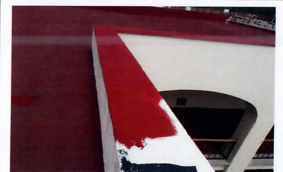
F19: Suministro y aplicación de impermeabilizante acrílico en azotea de segundo nivel del edificio
