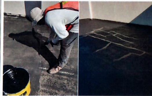
F15: Techo del edificio: Vista de los trabajos de calafateo en grietas de losa
