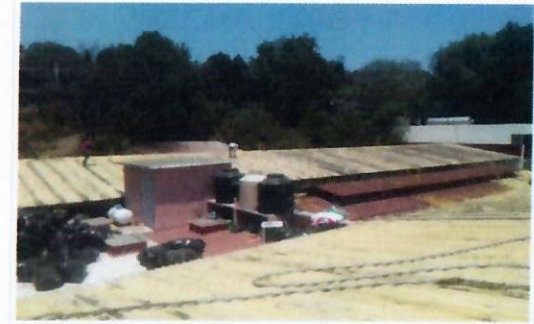
F8: Techo TAMULBA; Vista general de los trabajos de limpieza previas a la aplicación de impermeabilizante esprayado.
