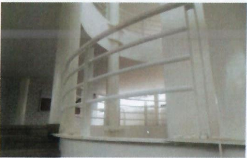
F34: Imagen de los trabajos terminados de aplicación de pintura de esmalte en barandales de vestibulo principal, área de laboratorios primer nivel edificio 35 FCQel.
