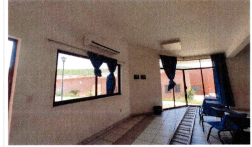
F8: (1) AIRE ACOND. AULA 5 DEL EDIF 07
