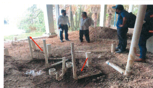
F10: Colocación de instalación hidrosanitaria en modulo de baños y laboratorio, rellenos y compactación, firme de concreto, colocación de loseta, fabricación de muros de tabique y vintex, cancelería, colocación de plafón, muebles sanitarios.
