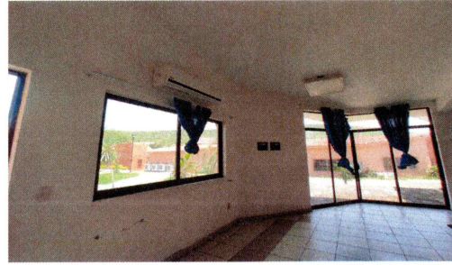
F7:(1) AIRE ACOND. AULA 4 DEL EDIF 07
