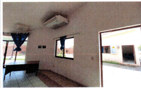
F3: (1) AIRE ACOND. AULA 1 DEL EDIF 06
