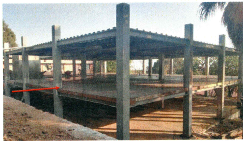
F1: Fachada Norte y Oeste - Construcción de la segunda etapa para la ampliación de laboratorios, cubículos de investigación, y oficinas académicas para el Centro de Investigaciones Biológicas antes CEIB (etapa final).
