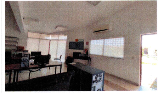
F5: (1) AIRE ACOND. CENTRO DE COMPUTO DEL EDIF 06
