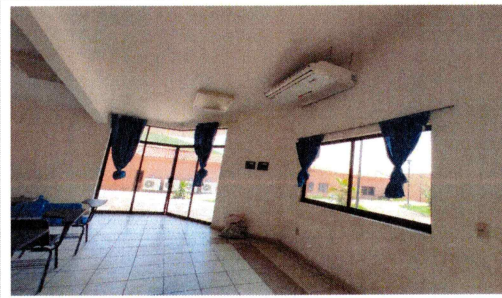
F4: (1) AIRE ACOND. AULA 2 DEL EDIF 06
