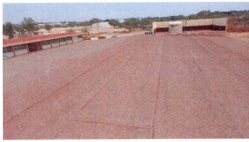
F4: Extremo Este de losa de azotea donde se realizarán los trabajos de mantenimiento al Impermeabilizante existente.
