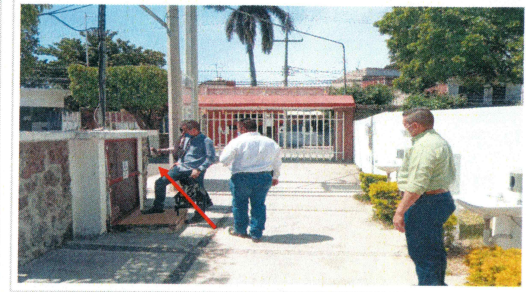
5.- Área de conexión general del sistema de paneles solares.
