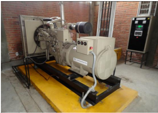
F1: Planta de emergencia
