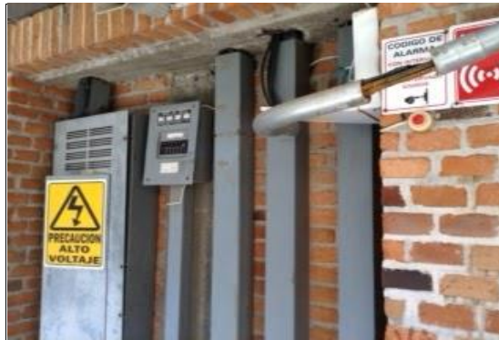
F2: Instalaciones Eléctricas
