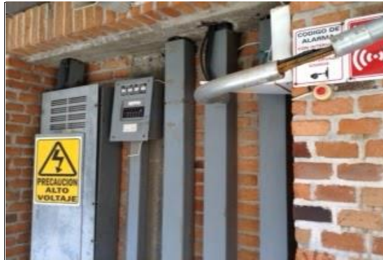
F2: Instalaciones Eléctricas
