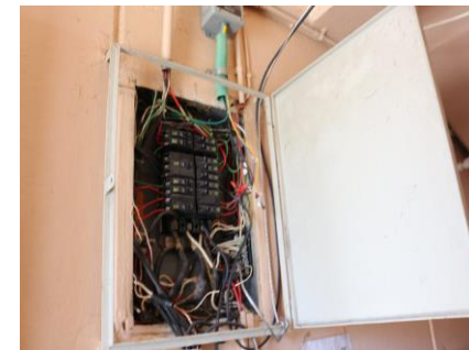
F5: Cableado Eléctrico
