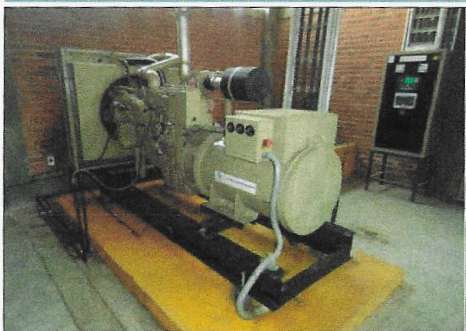
F1: Planta de emergencia
