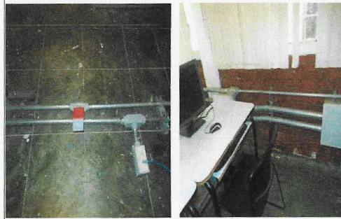
F2: Centro de Cómputo
