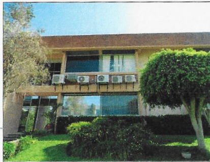
F3: Aires acondicionados
