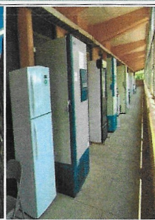
F5: Equipos de refrigeración y aires acondicionados
