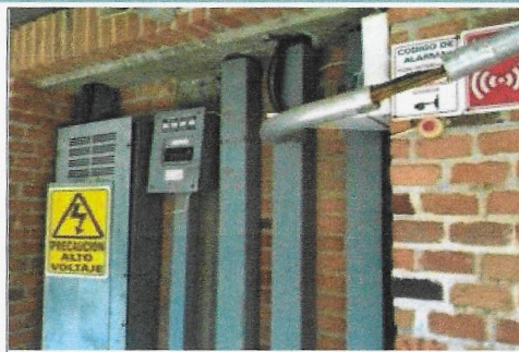
F2: Instalaciones Electricas
