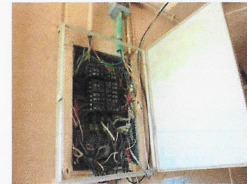
F5: Cableado Eléctrico
