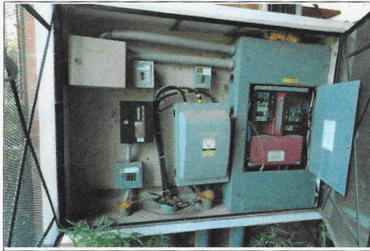
F2: Conductores eléctricos
