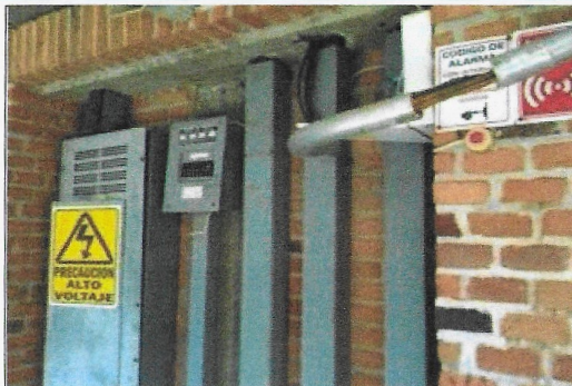
F2: Instalaciones Eléctricas
