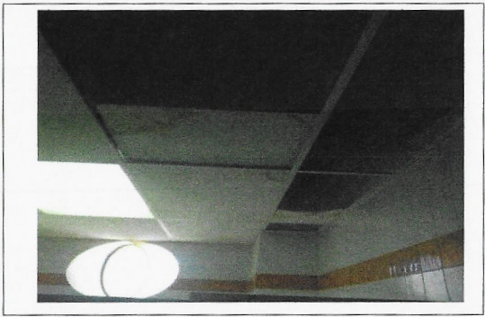
F5: Techo (Plafón)
