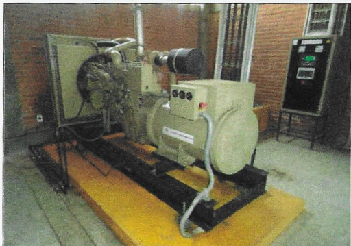
F1: Planta de emergencia
