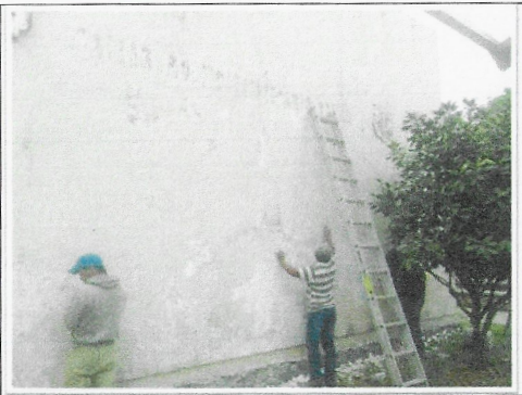
F6: TAMULBA: Limpieza de capas de pintura en mal estado sobre muros de fachada principal.
