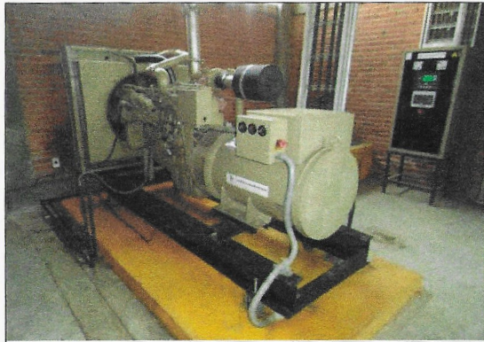
F1: Planta de emergencia
