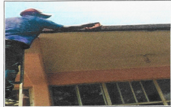
F19: Vista de los trabajos de preparación de la superficie para suministro y aplicación de pintura vinílica acrílica edificio 4 y 3
