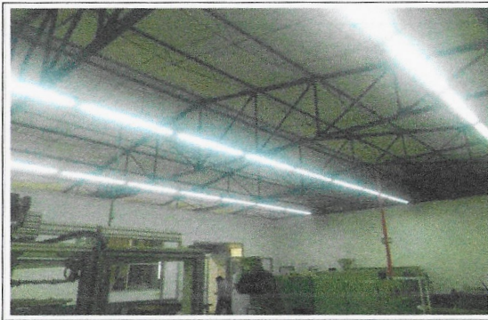
F24: Vista general de los trabajos concluidos de colocación de luminarias ahorradoras de energía tipo LED y su puesta en marcha. Laboratorios de TAMULBA
