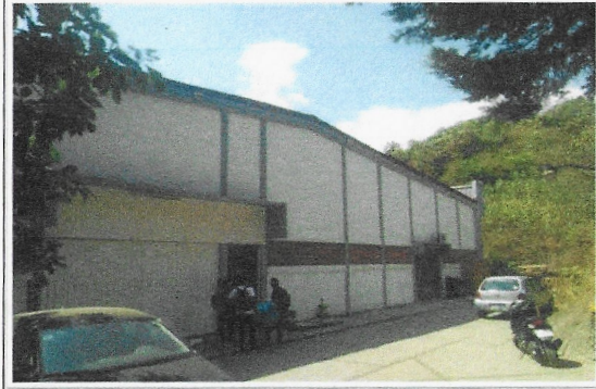
F21: LOU: trabajos concluidos de aplicación de pintura vinílica y de esmalte en fachada Principal.
