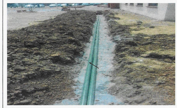
F8: Alimentador eléctrico de las dos cisternas
