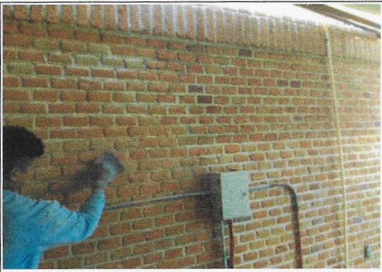
F1: Fachada principal (limpieza Limpieza de tabique aparente con lija y cepillo de alambre
