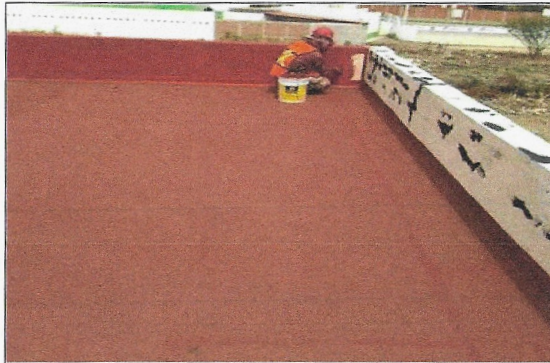
F18: Suministro y aplicación de impermeabilizante acrílico en azotea de segundo nivel del edificio
