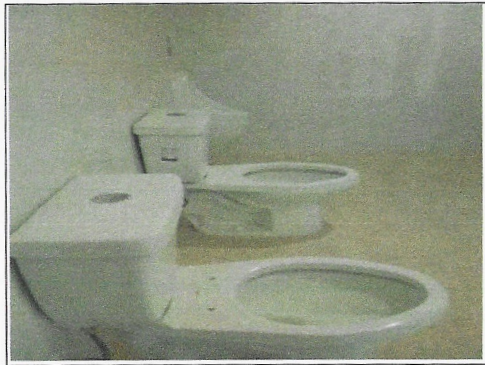
F8: Sanitarios: suministro y colocación de piso, azulejo, sanitarios, mingitorio ecológico (baño hombres)
