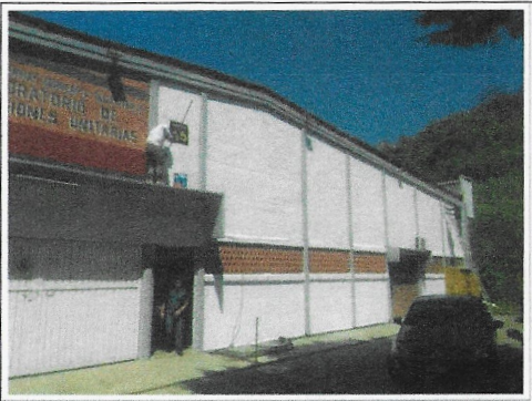
F10: LOU: Aplicación de pintura vinílica y de esmalte en muros de fachada principal.
