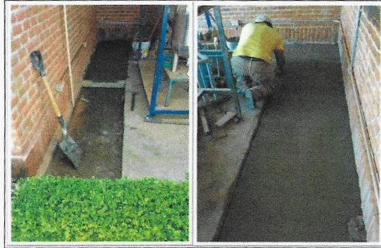
F7: Interior de aula (laboratorio) quitar adocreto, para colocar concreto acabado pulido y rayado (foto izquierda). Acabado al concreto ya terminado (foto derecha).
