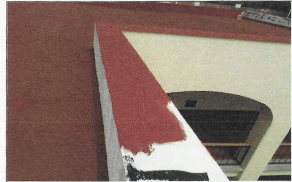
F19: Suministro y aplicación de impermeabilizante acrílico en azotea de segundo nivel del edificio
