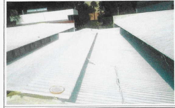
F11: Techo TAMULBA: Vista general de los trabajos terminados de impermeabilización a base espuma de poliuretano sobre cubiertas metálicas de edificio
