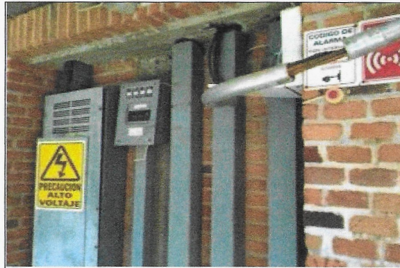
F2: Instalaciones Eléctricas
