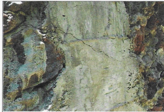
F4: Columna de concreto de muro de contención fisurado
