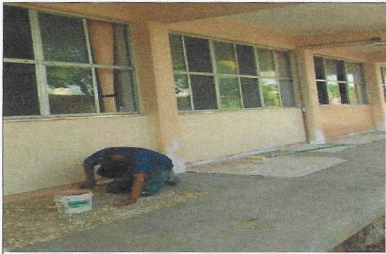
F18: Vista de los trabajos de suministro y aplicación de pintura vinílica acrílica edificio 4 y 3
