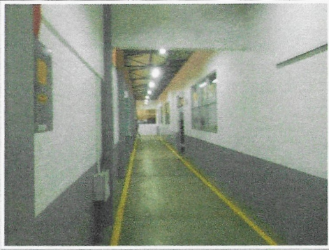
F17: TAMULBA-FCQel: Trabajos concluidos de aplicación de pintura vinílica y de esmalte en muros de pasillos interiores.
