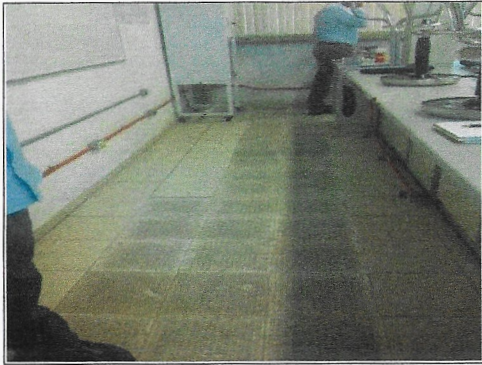
F7: Piso de laboratorio dañado
