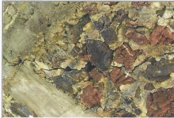
F2: Muro de contención que soporta al muro de colindancia dañado, con diferentes fisuras
