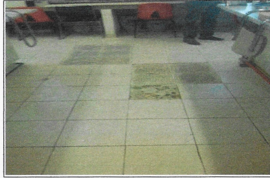
F8: Piso de laboratorio dañado
