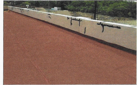
F16: Suministro y aplicación de impermeabilizante acrílico en azotea de segundo nivel del edificio
