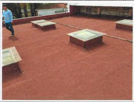
F15: Vista general de los trabajos terminados de colocación de membrana de impermeabilizante prefabricado en cubierta de TAMULBA.
