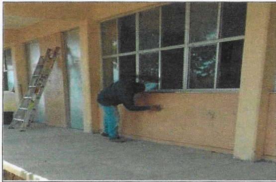
F15: Vista de los trabajos de preparación de la superficie para suministro y aplicación de pintura vinílica acrílica edificio 4 y 3
