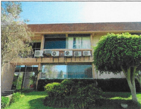
F3: Aires acondicionados
