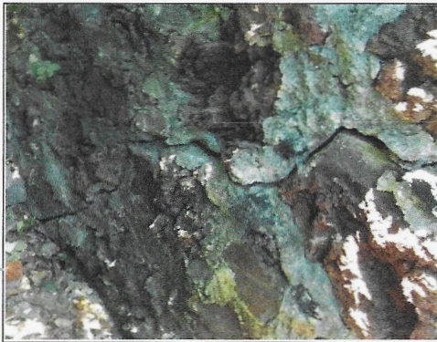
F3: Muro de contención con varias fisuras
