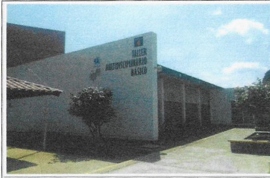
F18: TAMULBA-FCQel: Trabajos terminados de aplicación de pintura vinílica en muros de fachada principal así como de pintura de esmalte en estructura y puertas metálicas.
