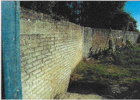
F1: Muro dañado
