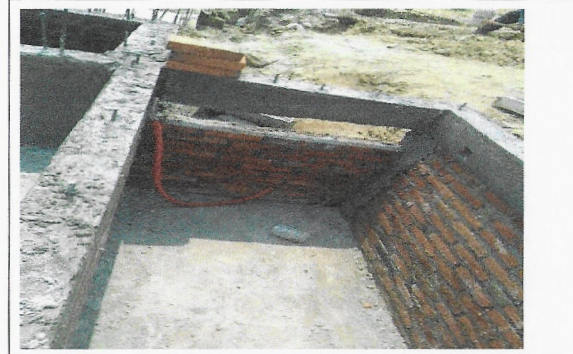
F11: Trabajos en el carcamo seco y paso de las dos cisternas
