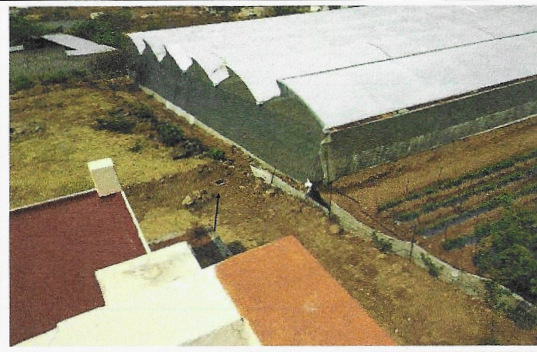
F7: El alimentador eléctrico está en proceso de construcción, que dará energía a las dos cisternas que se están construyendo
