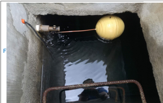
F5: Interior de sistema
