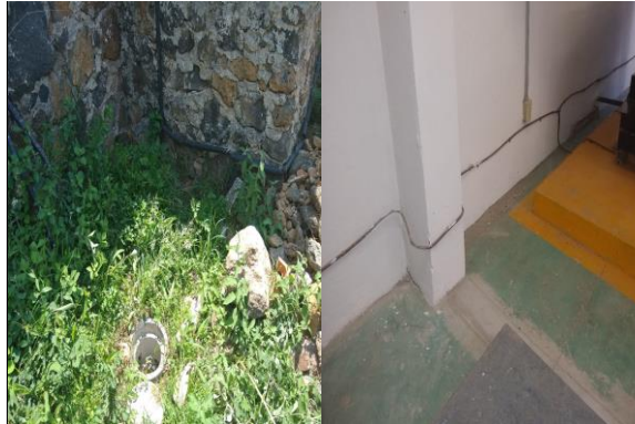
F2: Sistema de tierras físicas
