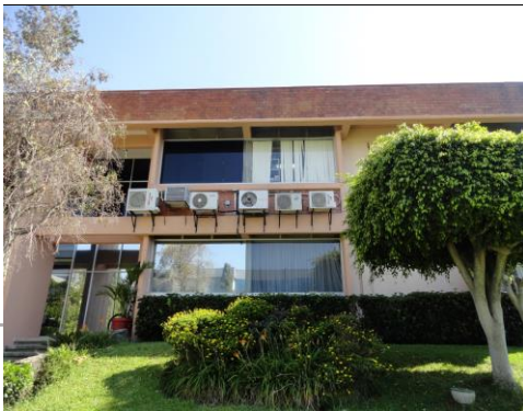
F3: Aires acondicionados
