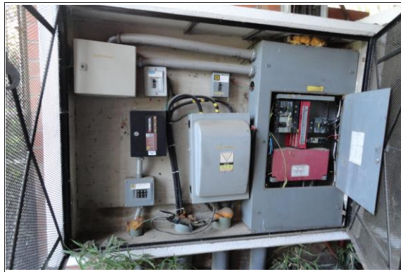
F2: Conductores eléctricos
