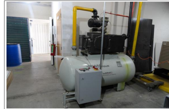
F5: Bomba General de vacío
