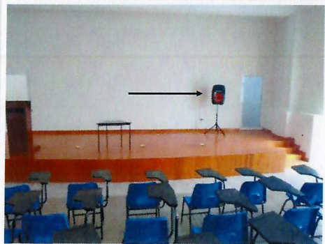
F17: Bafle instalado en el Auditorio.
