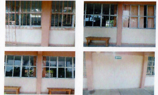
F11: Colocación de extintores afuera de pasillo edificio 1, pasillo de edificio 3 y pasillo de edificio 2.
