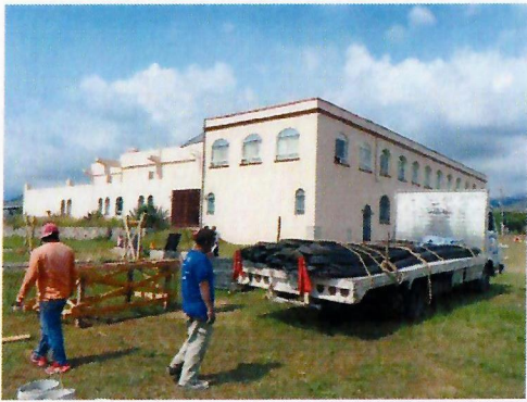
F6: Se inician trabajos en la estructura del edificio para la construcción de los contrafuertes.
