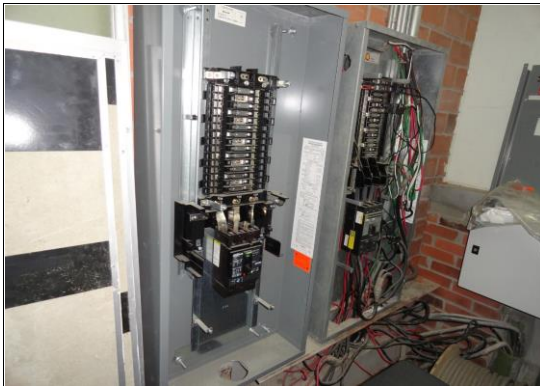
F1: Tableros eléctricos actuales
