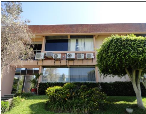
F3: Aires acondicionados
