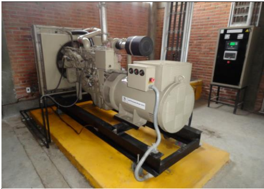
F1: Planta de emergencia
