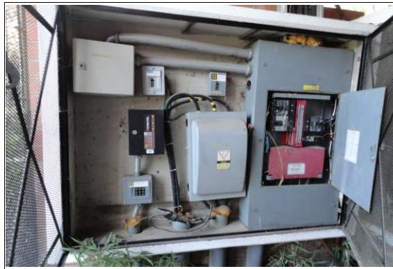
F2: Conductores eléctricos
