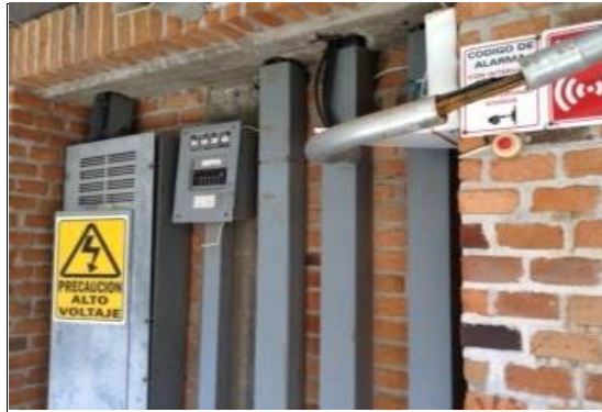
F2: Instalaciones Eléctricas
