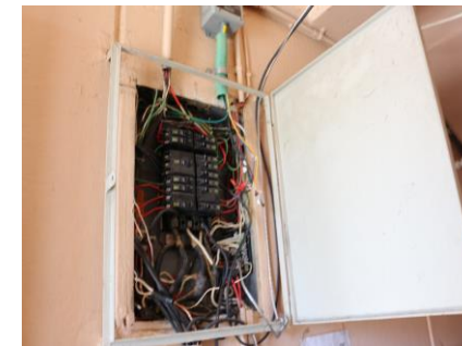
F5: Cableado Eléctrico
