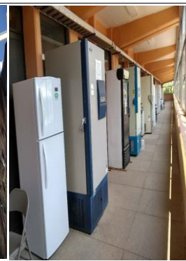
F5: Equipos de refrigeración y aires acondicionados
