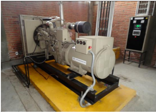
F1: Planta de emergencia
