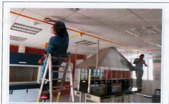
F31: Aplicación de pintura de esmalte en tubería de cobre, para distinguir la conducción de gas LP en laboratorio. (LOB)
