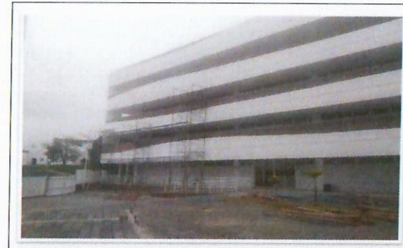
F28: Vista general de los trabajos de aplicación de pintura vinílica en muros de fachadas, primer y segundo nivel, área exterior sur de laboratorios edificio 35 FCQel.
