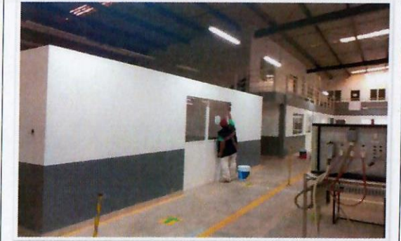
F22: LOU. Trabajos de aplicación de pintura vinílica y de esmalte en muros interiores.
