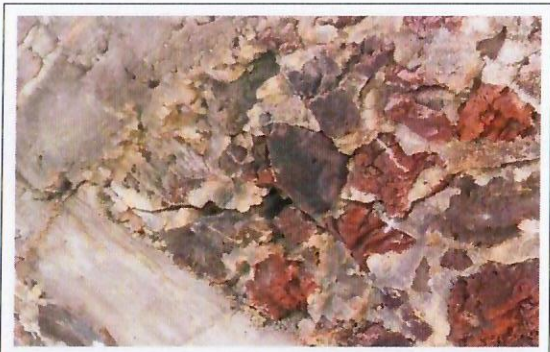
F7: Muro Perimetral con diferentes fisuras
