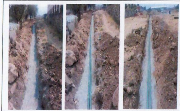
F18: Alimentador eléctrico.
