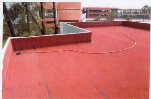
F28: Vista general de los trabajos terminados de impermeabilización prefabricado en losa de anexo TAMULBA.
