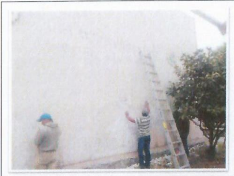
F15: TAMULBA. Limpieza de capas de pintura en mal estado sobre muros de fachada principal.
