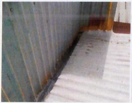
F24: Vista general de limpieza en canalones metálicos adyacentes a cubierta metálica de LOU, previos a su reparación en áreas deterioradas.
