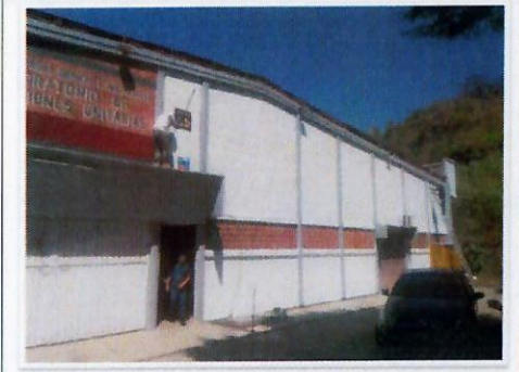
F19: LOU. Aplicación de pintura vinílica y de esmalte en muros de fachada principal.
