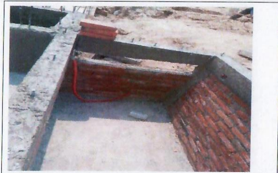
F11: Trabajos en el carcamo seco y piso de las dos cisternas
