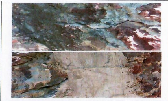
F8: Muro y columna de barda Perimetral con varias fisuras
