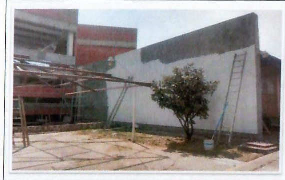
F18: TAMULBA. Aplicación de pintura en muros de fachada con preparación previa para recibir trabajos.
