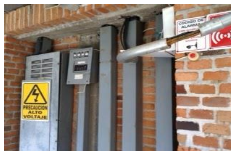
F2: Instalaciones Eléctricas
