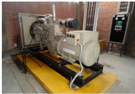
F1: Planta de emergencia
