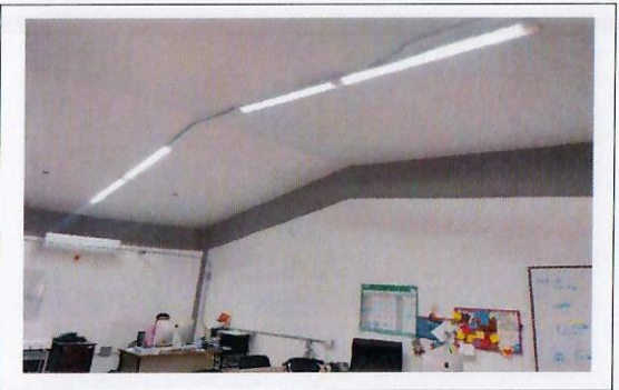
F35: Lámparas instaladas
