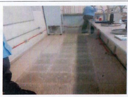
F10: Piso de laboratorio dañado
