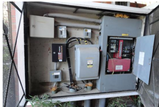
F2: Conductores eléctricos
