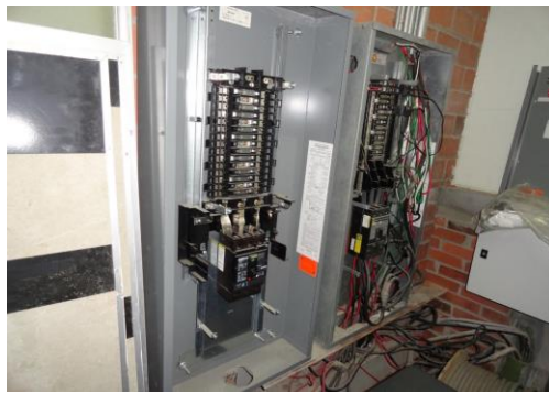
F1: Tableros eléctricos actuales
