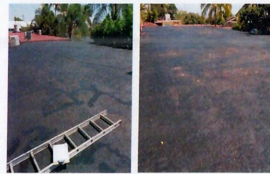
F10: Techo: trabajos de calafeteo en grietas de losa en edificios 3A y 4.
