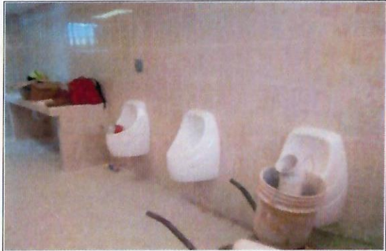
F21: Sanitarios: mingitorios ecológicos, barra para ebalinas y otulinas nuevos
