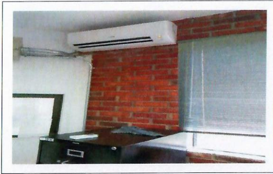
F41: Mini split instalado
