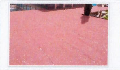
F18. Acabado final en memoria de impermeabilizante prefabricado en losa de azotea, planta baja de Edificio Ciencias.
