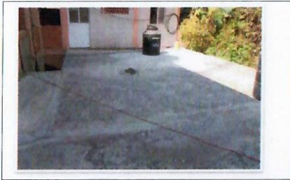
F12. Vista general de la zona de azotea con trabajos previos de limpieza para recibir material de base.
