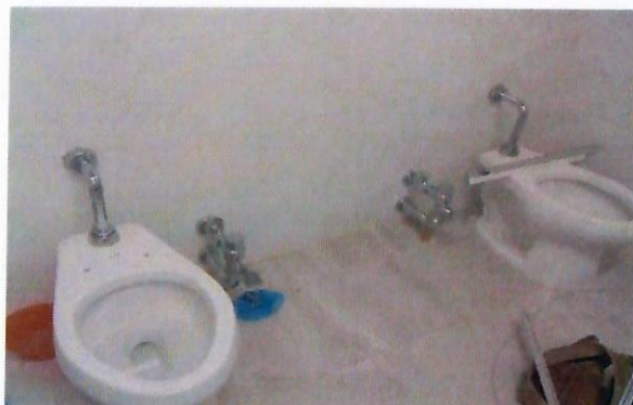
F35: azulejo, piso y sanitarios con fluxómetro de pedal nuevo (mujeres)
