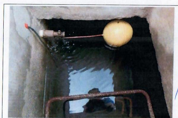
F5: Interior de sistema
