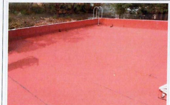
F29: Imagen de trabajos concluidos de impermeabilización con membrana prefabricado hacia fachada norte de anexo TAMULBA.
