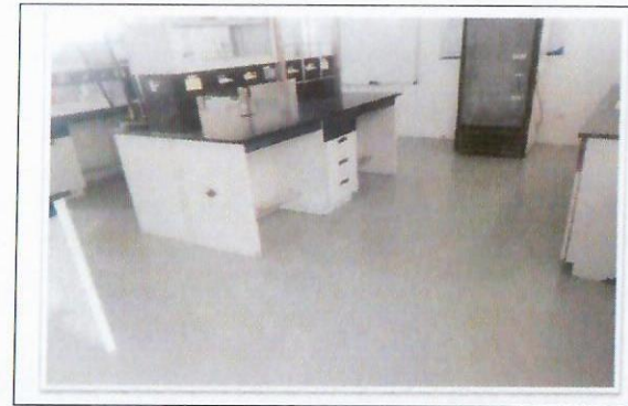
F55: Trabajos terminados de aplicación de pintura epóxica en piso de laboratorio primer nivel de edificio 35 FCQel.
