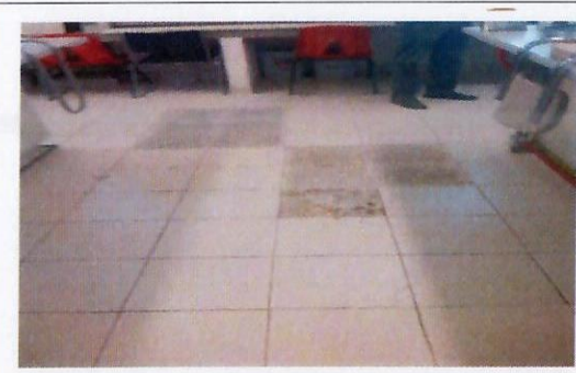
F11: Piso de laboratorio dañado
