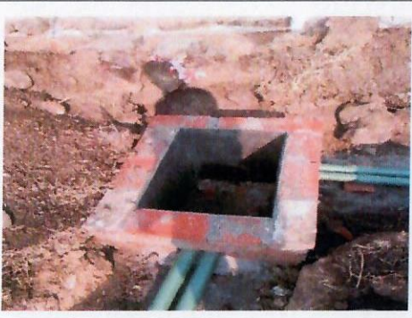
F9: Alimentador eléctrico de las dos cisternas
