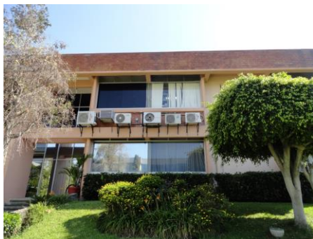
F3: Aires acondicionados
