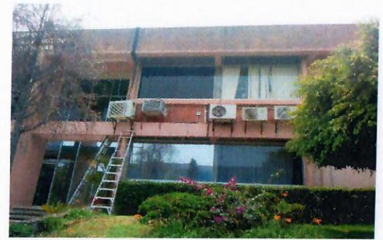
F8: Aires acondicionados
