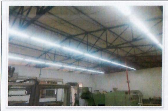
F48: Vista general de los trabajos concluidos de colocación de luminarias ahorradoras de energía tipo LED y su puesta en marcha. Laboratorios de TAMULBA
