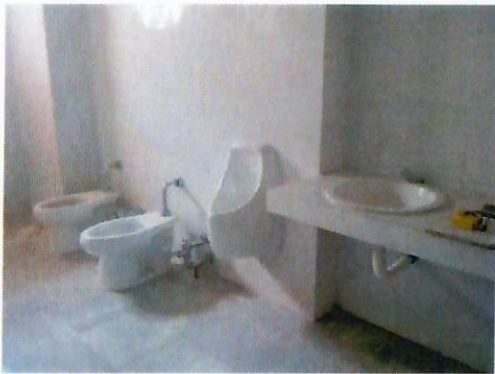
F34: Azulejo, piso, sanitarios con fluxómetro de pedal, mingitorio ecológico y barra con obalines, todo nuevo (hombres)
