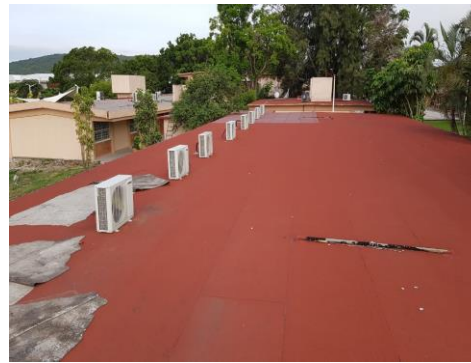
F2: Retiro y colocación de impermeabilización en el Laboratorio E-6 y E-7
