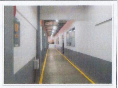
F41: TAMULBA-FCQel: Trabajos concluidos de aplicación de pintura vinilica y de esmalte en muros de pasillos interiores.
