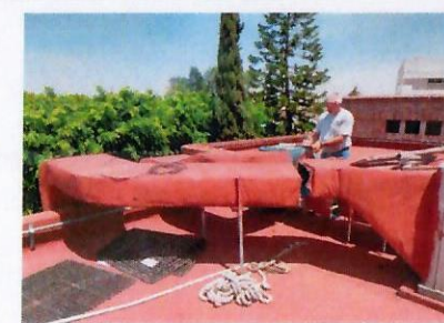
F17: Mantenimiento azos acondicionado
