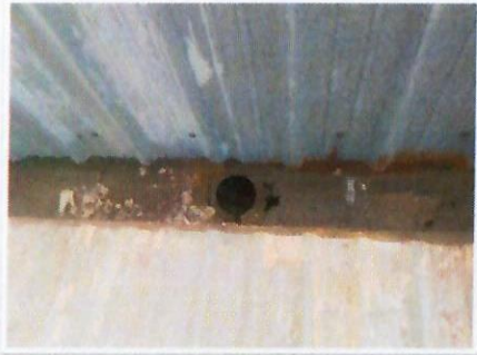
F21: Vista general de limpieza en canalones metálicos adyacentes a cubierta metálica de LOU, previos a su reparación en áreas deterioradas.
