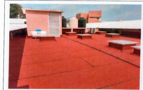
F15: Colocación de membrana de impermeabilizante prefabricado en losa de acceso cesto. TAMULBA
