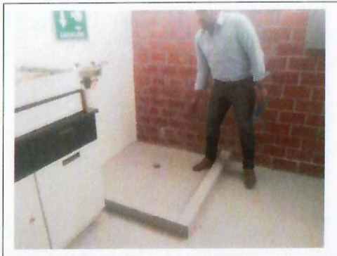
F6: Se aplicará Pintura epóxica en paredes de laboratorios (sardineles y piso de regaderas.) LOU
