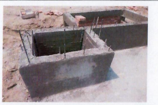
F10: Trabajos en el carcamo seco y piso de las dos cisternas
