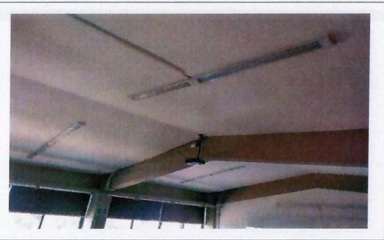
F36: Lámparas instaladas
