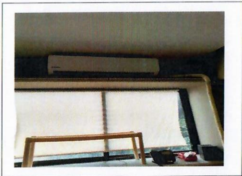
F40: Mini split instalado
